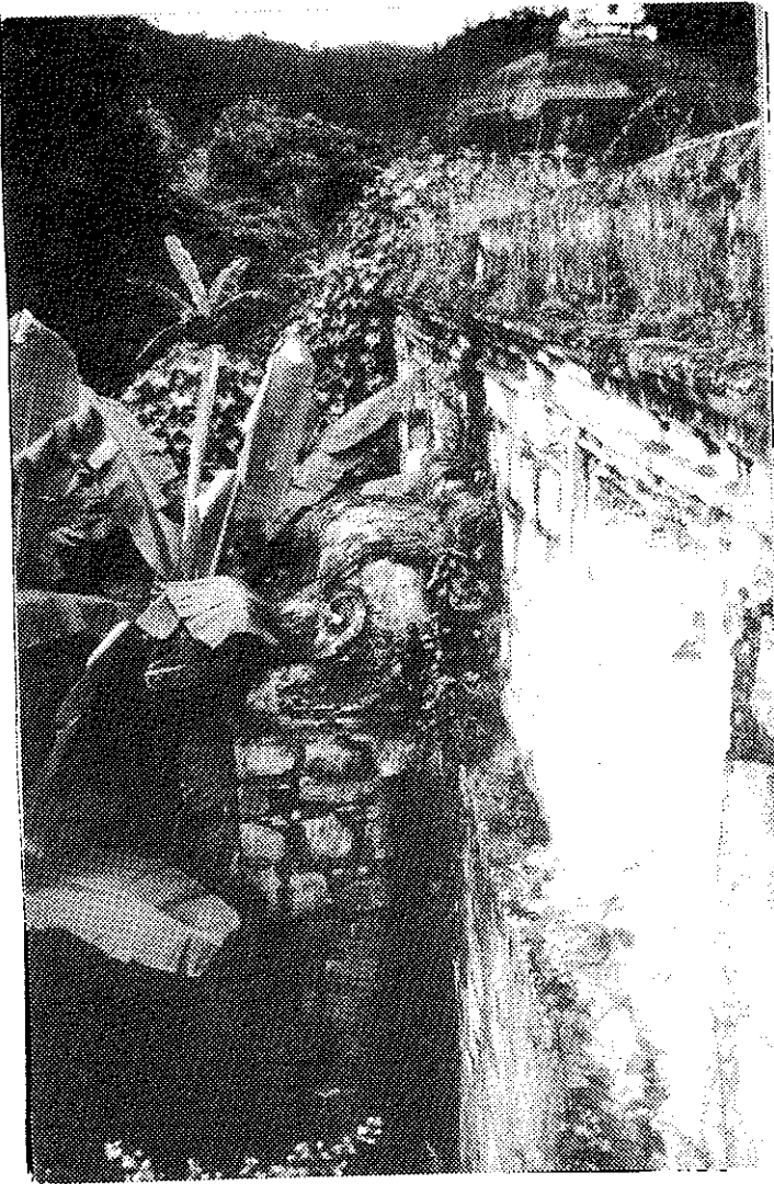
FOTO N.17 Presencia de flora, hongos y musgo en muros, y contrafuertes del muro lateral norte.
