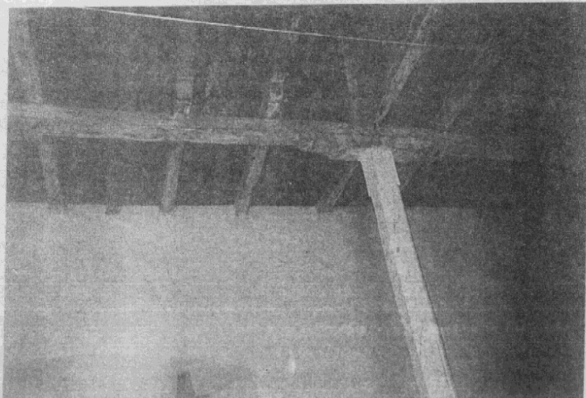
FOTOGRAFIA No. 26: Artesonado de la cubierta. Tiene flanbeo por humedad en las vigas principales.
