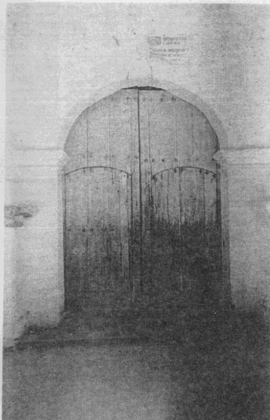
FOTOGRAFIA No. 15: Puerta de ingreso a la nave principal Sus deterioros son: humedad, hongos y material faltante.
