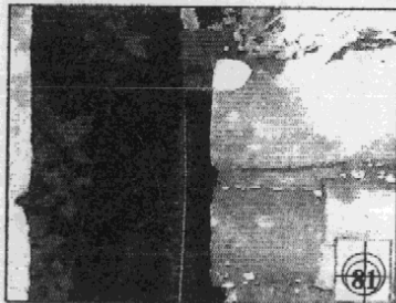
Se puede apreciar la macroflora sobre la cubierta y el muro, debido a la falta de mantenimiento
