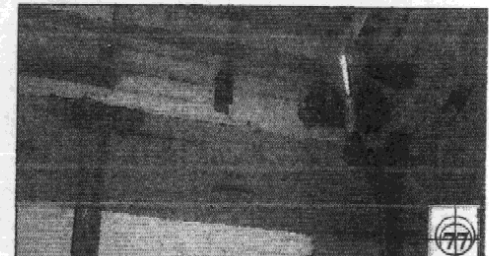
Se aprecia la falta de cielo suspendido en algunas áreas
