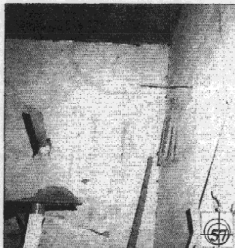
Otra vista del mismo ambiente, donde se puede observar, como la humedad y la falta de mantenimiento ha deteriorado los muros y el cielo falso, además el el abandono en el que se encuentra dicho ambiente
