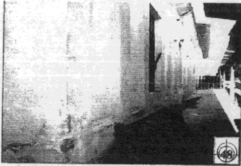
Vista de la elevación lateral sur y algunos deterioros
