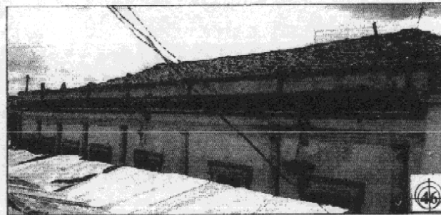
Vista del muro lateral sur del edificio, donde se puede apreciar el deterioro, debido a la Humedad (presencia de microflora y desprendimiento de acabado)
