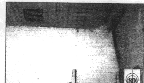
En este ambiente se puede apreciar lo dañado del muro por la humedad y falta de mantenimiento
