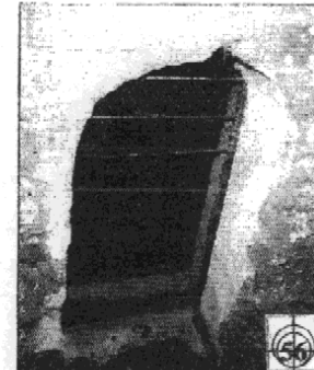
Vista de la misma ventana, desde el exterior, (se observa excesiva humedad y presencia de microflora)
