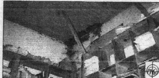
Se observa el daño causado por la humedad en el cielo falso
