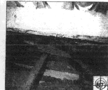
Aquí, una sección, donde el cielo falso esta dañado, además se observa gran cantidad de segmentos de tejas
