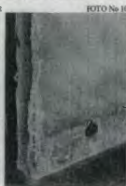
Vista de vapo de muni erosionado por el paso en la puerta, además de golpes sufridos. Caja de tomacorrientes sin dados.
