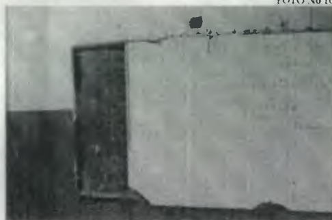
Pizarra en mal estado por el uso y por golpes recibidos, además de la falta de mantenimiento.
