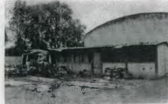
Vista del taller de tres ambientes, al fondo la parte posterior del auditorio, al fondo el aula parcialmente caída porque un árbol viejo le cayó encima. Foto tomada desde el área de ingreso por la Escuela Anexa.
