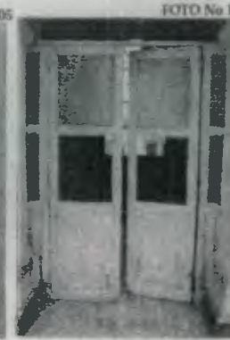
Puerta de madera y vidrio, que da del vestibulo de ingreso interno al pasillo Sur del instituto.
