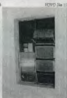
Ventana típica de las aulas, las cuales dan a los pasillos. Se ve el mal estado de estas por la falta de vidrios y herriería.
