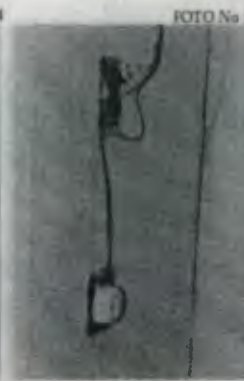
Interruptor sencillo, que se desprende del interruptor original doble, en el cual los dados no funcionan.
