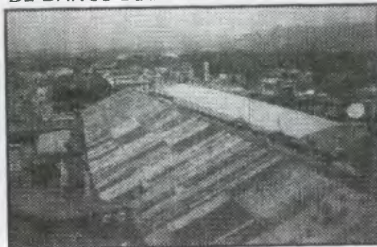
Foto No. 54 Se observa la oxidación en las láminas y la forma de la cubierta que no es la original.
