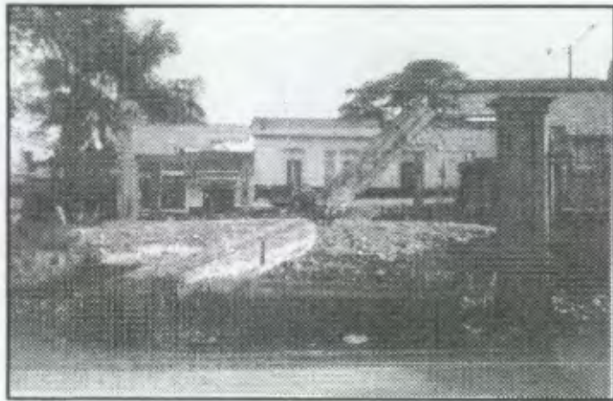
Foto No.31 : Los escombros del Kiosco demolido dan un mal aspecto, como espacio sin uso alguno.
