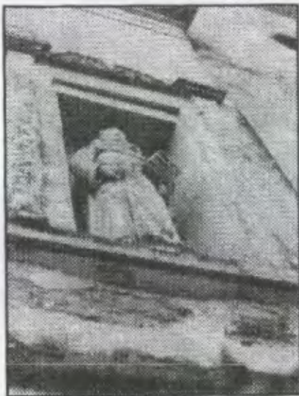
Foto No.58 Los desprendimientos de acabados provocados por condiciones climáticas dañan severamente los materiales
