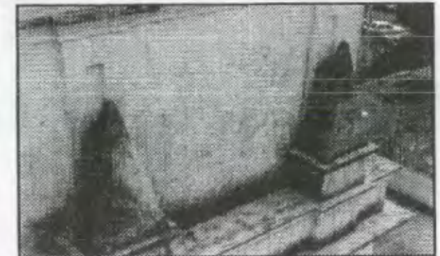
Foto No.62 Se puede observar el deterioro en el muro del campanario por la parte de atrás por efectos climáticos combinados por la presencia de las palomas.
