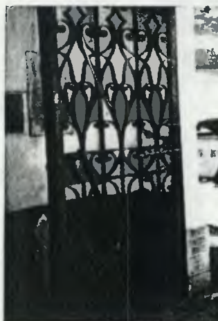
Foto N. 10 Fuente: Levantamiento de campo Detalle del portón de ingreso principal, sobre la 9a. calle zona 1, al edificio municipal
