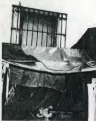
Foto N.13 Detalle de ventanas ubicadas en la fachada lateral. (sin vidrio ni marco).
