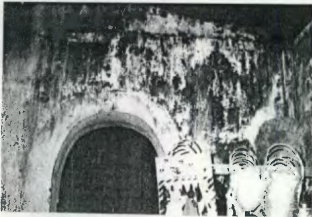
Foto N. 32 Deterioro en muros de mampostería. (manchas de Mohos)
