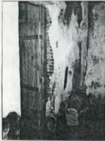
Foto N. 26 Deterioro y agregados en marcos de puertas.
