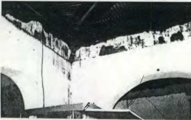
Foto N. 15 Puede observarse el desprendimiento de cernido en muros, y la estructura del techo provisional.
