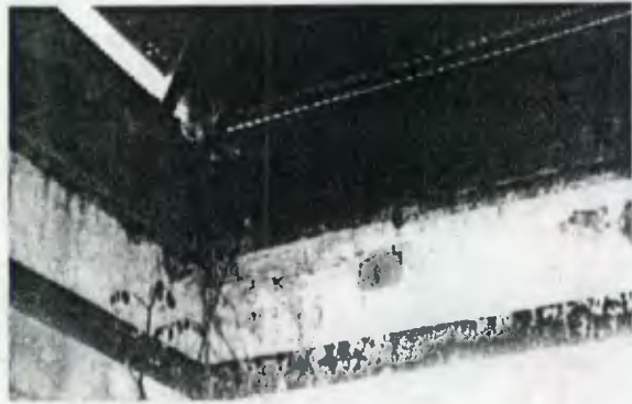
Foto N. 25 Vegetación en parte superior de muros.
