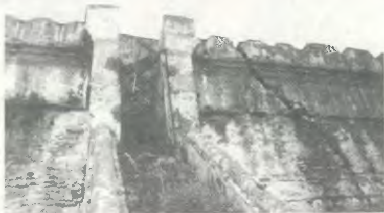
Fotografía 33, muestra el muro posterior del templo. Note la grieta desde la parte superior y el deterioro de gradas y muro por la flora y manchas entre otros.
