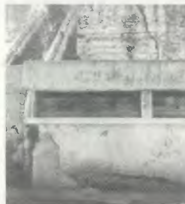
Fotografía No. 34, vista desde la calle, muestra el deterioro del templo por la construcción de los servicios sanitarios del mercado.
