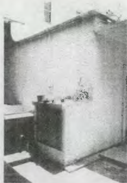
FOTO 35 se observa cómo se ha agregado la casa que guarda la cisterna.
