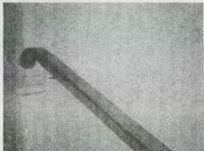
FOTO 6 se observa en el abandono en que está este pasamanos ubicado al ingreso, casi desprendido de la pared y la madera con rayones y desgastada.
