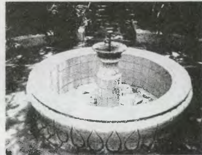
FOTO 14 vista de la fuente, la cual se encuentra en completo abandono, está sucia y con microflora y algunos de sus azulejos tienen grietas.
