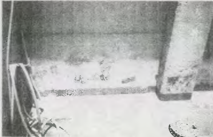
FOTO 37 se observa cómo la microflora y las sales han afectado y deteriorado la parte baja de esta pared, al mismo tiempo sufre de desprendimiento del material de repello y pintura.
