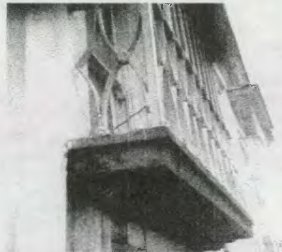
FOTO 4 otro balcón que ha sufrido daños y el cual también ha sido reparado, se observa que en algunos casos el hierro está despintado.
