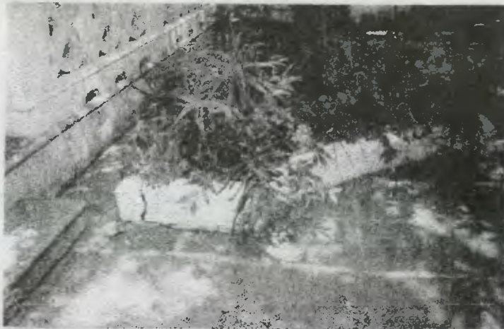
FOTO 13 vista del jardín interior que muestra aparición de vegetación, fisuras y grietas tanto en las jardineras como en el piso de cemento que además presenta microflora debido a la humedad.
