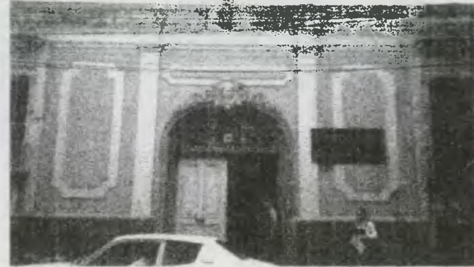
FOTO 2 Se muestra el mascarón sobre la puerta, los cables sueltos de electricidad y el rótulo que identifica al edificio como juzgado.
