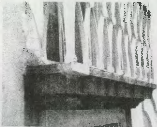
FOTO 3 se observa como ha sido mutilado parte de la base del balcón y como la han reparado.
