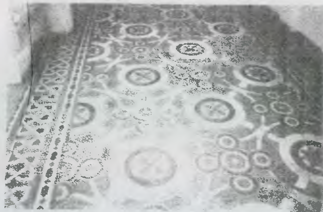
FOTO 26 vista del piso de los corredores, entrada y vestíbulo, se observa el agrietamiento y la abrasión que presenta debido al uso y la falta de mantenimiento.
