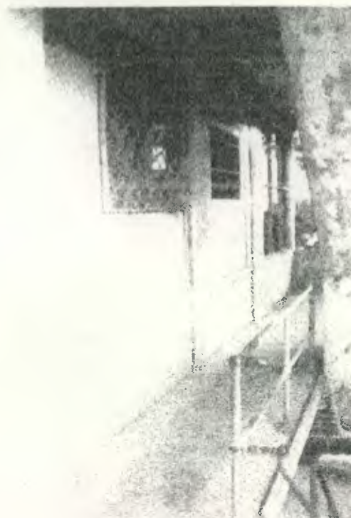
15. Corredor del segundo nivel, elevación frontal, se observa alteración en cerramiento de ventaneras, pasamanos de gradas en mal estado debido a la falta de mantenimiento.
