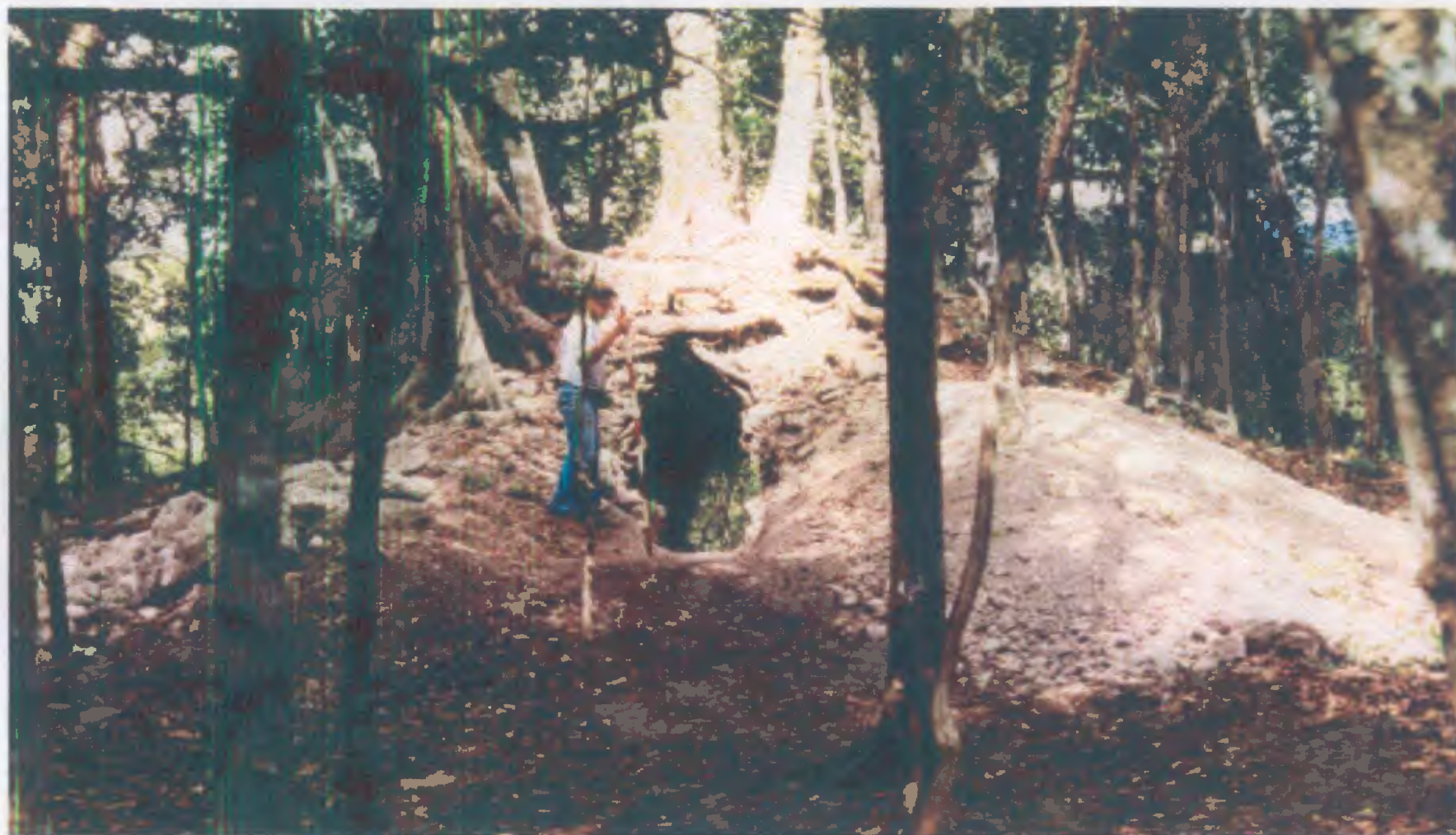
Detalle de trinchera de saqueo TS-15 localizada en el edificio A-13, vista al poniente. Nótese la severidad del daño estructural que ocasionan las raíces de los árboles así como los provocados por el espolio ( ver anexo folio No.8/23 ).
