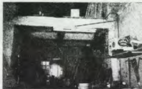
Vista de ambiente de mantenimiento, está totalmente afectado, en piso deteriorado y faltante, al igual de muros, cubierta, no existe cielo falso, se sellaron ventanas y puertas.
