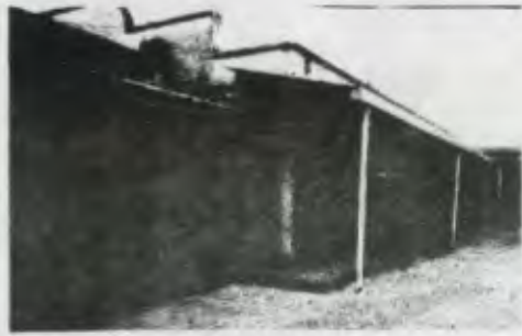
Vista de pasillo de entorno a Casa 1 A, se utiliza lámina y columnas de metal, se encuentran manchas en muros, se observa oxidación en lámina, se selló portón de ingreso.
