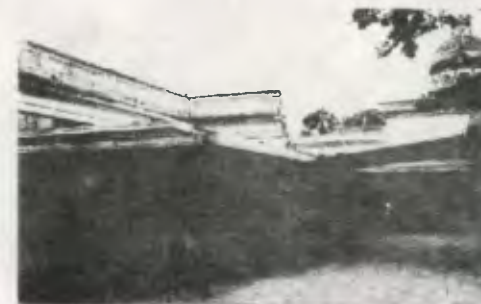
Vista de muro Escuela Práctica de Señoritas, bodegas, s.s., comedor niños y pasillos, estilos que contrastan por falta de conocimiento, se observa manchas, humedad, oxidación.
