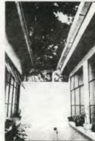
Vista pasillo en que se sello ingreso, instalaron pilas, inst. hidráulica expuesta, cubierta del pasillo improvisada de lámina de zinc.
