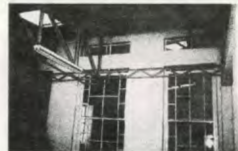
Vista de interior coclna, se observa nueva cubierta, falta integración de cielo falso, las instalaciones de gas, eléctricas e hidráulicas expuestas.
