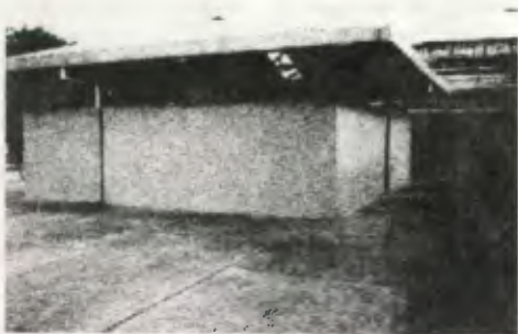
Vista de kiosko utilizado para comedor de niños, el piso es la torta de cemento del patio, carece de insta. eléctricas, las mesas fueron fundidas de concreto recientemente.
