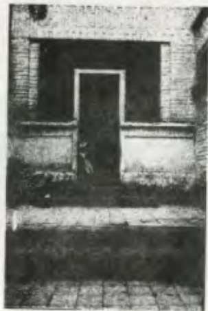
Vista Exterior de Consulta Externa. se observa desprendimiento de acabados, muro manchados, piso y gradas con fisuras.
