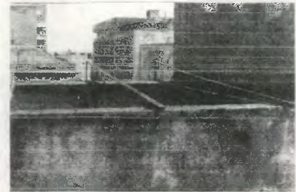
FOTO No. 144 Estructura metálica agregada al pozo de luz. Presencia de hongo en muros.
