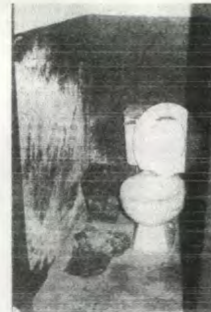
FOTO No. 147 Artefactos sanitarios en mal estado. Piso decolorado y sales y hongos en muros.
