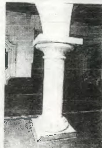
FOTO No. 113 Columna de concreto reforzado con anillos tanto en el capitel como en la basa.
