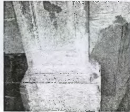
Foto No. 51 La columna también tiene desprendimientos en sus acabados, algunas partes han sido repelladas, muestra una fuerte decoloración al igual que toda la casa.
