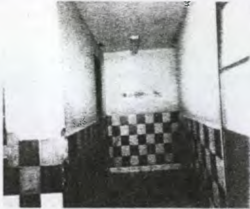
Foto No. 55 Este es el ingreso del edificio anexo el cual presenta varios desprendimientos en sus acabados, observar los muros y los zócalos.
