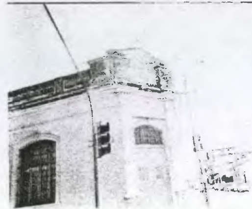
Foto No. 44 En la fachada del ochavo existen varios daños y alteraciones, como humedad, desprendimientos y colocación de rótulos.
