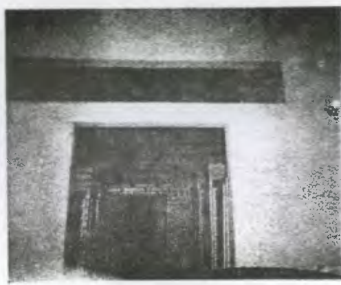
Foto No. 36 Este es el Servicio Sanitario del personal, al cual le falta la puerta principal y el material de la ventana que esta arriba.
