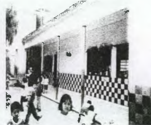
Foto No.60 al igual que en el edificio antiguo las ventanas de las aulas les hace falta el vidrio, los sobremarcos son de madera los cuales están dañados por los efectos de la polilla.
