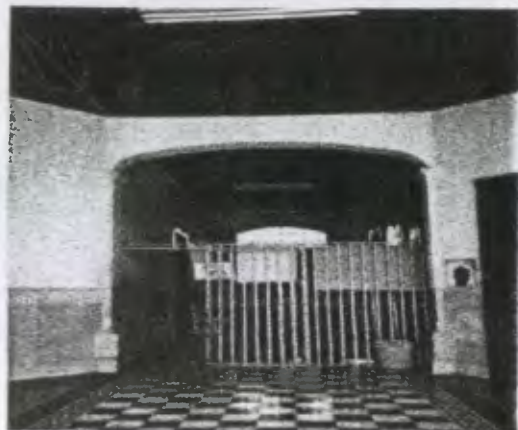
Foto No. 15 Este es el arco que se encuentra en el vestíbulo del ingreso, el cual ha sido alterado por la colocación de un portón de rejas.
