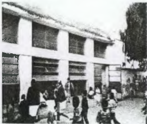
Foto No.59 el patio es el único lugar de recreación que tienen los niños, el Salón de Usos Múltiples tiene algunos vidrios quebrados, oxido en ventanas y puertas, y presencia de humedad en la cenefa.
