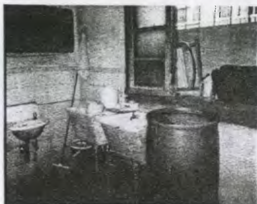
Foto No.9 Este es uno de los Servicios Sanitarios de los niños, el cual se mantiene bastante húmedo por la utilización de agua en los tambos, las ventanas exteriores son utilizadas para colocar cosas.
