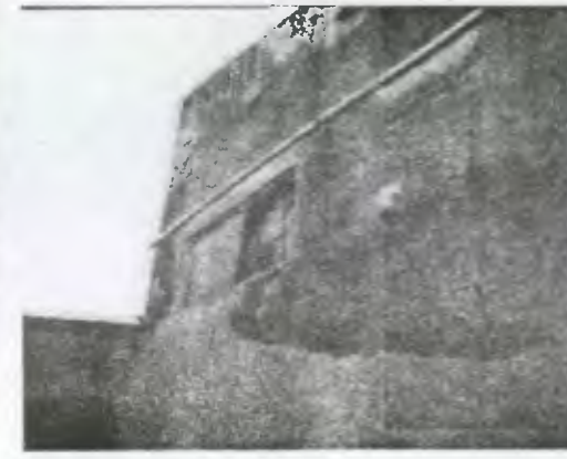
Foto No.38 al subir las gradas nos encontramos con este ambiente, en su exterior presenta daños en la pared y falta de material en la ventana.
