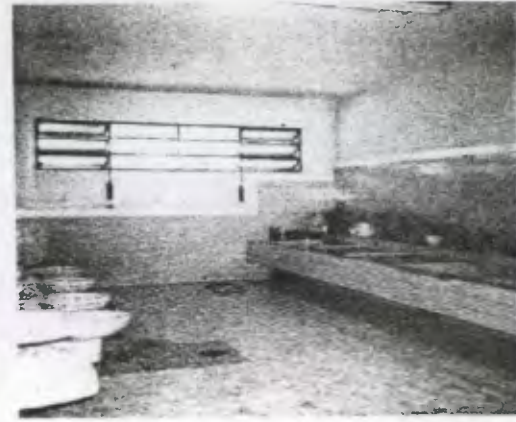
Foto No.64 algún sanitario ha sido reparado por lo que se ha tenido que remover el piso, colocando después otro diferente y dejando algunas rajaduras en el suelo.
