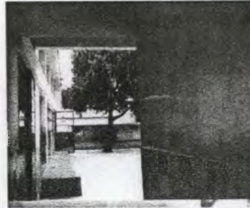
Foto No. 68 Aquí se ve la banca que fue agregada en el patio. Las paredes que se ven al final presentan humedad y suciedad.
