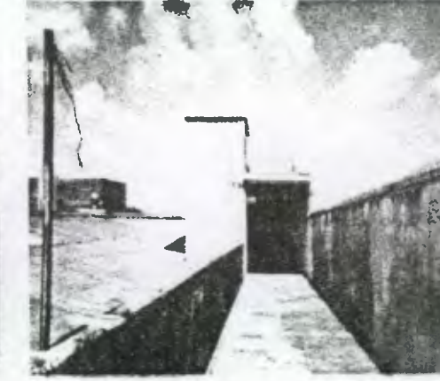
Foto No. 41 Este es el lado opuesto de la foto anterior, observándose la gran humedad que existe en las paredes, así como manchas y microflora, al final se encuentra el vestidor del personal de cocina al cual le falta la puerta.
