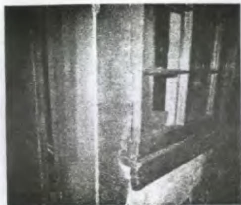
Foto No.35 En esta foto se aprecia el mal estado en que se encuentran las ventanas de la casa, con decoloración, apollilladas y con rajaduras.
