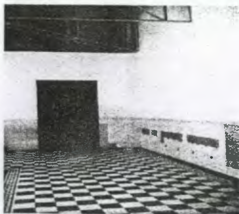
Foto No. 11 desde el corredor se ve la puerta anterior, en este corredor fueron quitados los lavabos, en el zócalo de cemento líquido se ven los agujeros de la instalación, vemos la colocación de piezas de diferente color en el zócalo.
