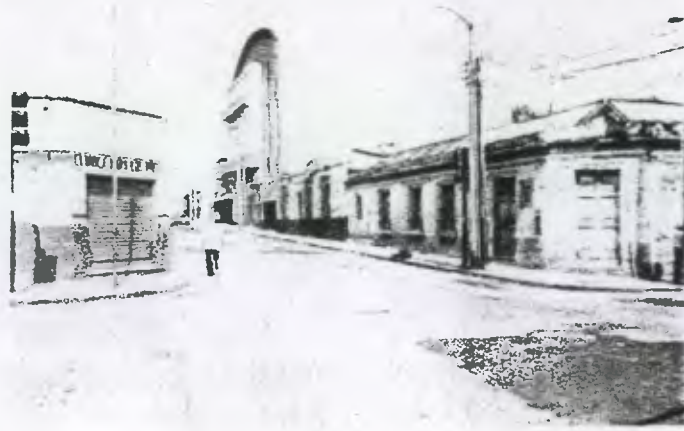
Foto No.6 En esta área siempre predominó el estilo Neoclásico, como se puede observar en la casa de la esquina de la 14 avenida, la cual se encuentra deteriorada, existe desintegración arquitectónica.
