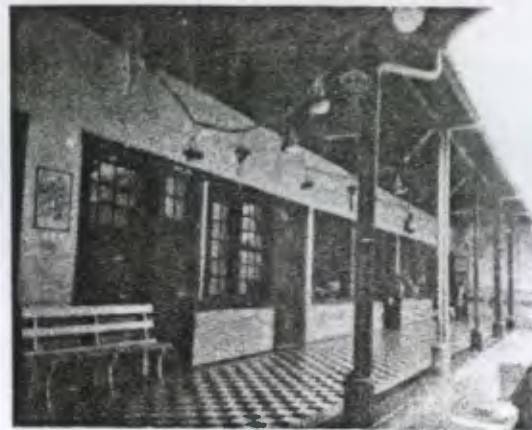
Foto No.2 Este es uno de los corredores de la casa en el que se aprecia la falta de material en algunas ventanas, y el techo sin machihombre.
