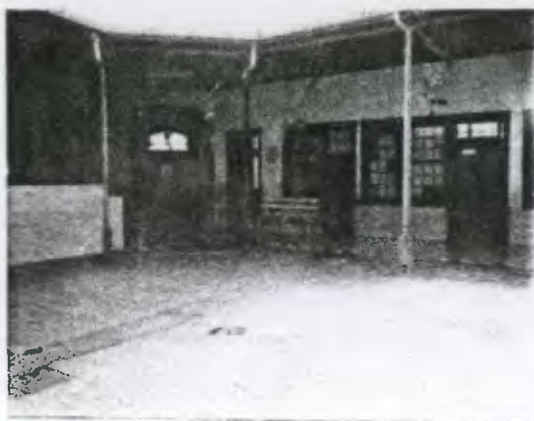
Foto No.1 Este es el interior de la Casa en donde se observa el arco en el vestíbulo del ingreso, se ve el piso del patio con algunos daños.
