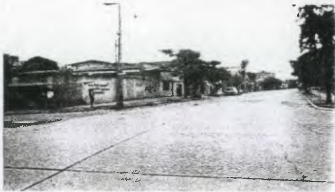
Foto No.26 Esta es la avenida Juan Chapín o 12 avenida se ubica enfrente del Parque del Cerrito del Carmen. Es un área donde hay comercios, viviendas y la cual se ve afectada por ventas callejeras, asfalto deteriorado, postes y rótulos.
