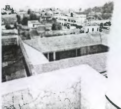
Foto No. 0 Esta foto muestra el techo de la Casa del Niño No.2 algunas laminas se encuentran en mal estado.
