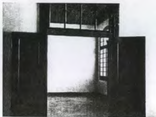
Esta área es actualmente la clínica, la cual ha cambiado debido a algunas alteraciones de tabiques. observar el machucambre el cual ahora ya no existe. las puertas y ventanas son las originales aunque deterioradas.
