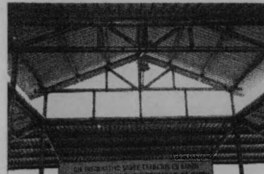
FOTOGRAFIA 3. VENTILACION CENITAL DEL SALON DE USOS MULTIPLES
