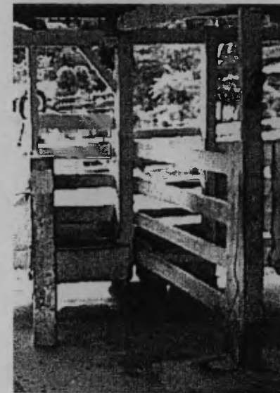
Fotografía 80. MANCHAS DE HUMEDAD EN BASE DE COLUMNAS Y BRETES
