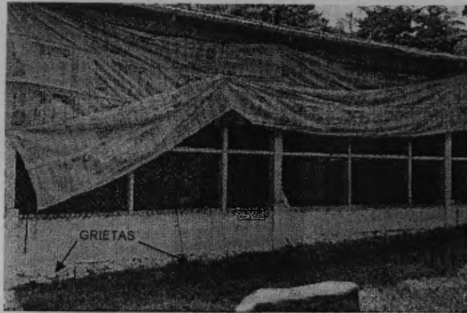
Fotografía 100. GRIETAS EN MUROS
