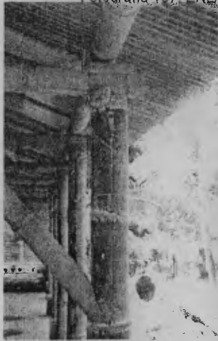
Fotografía 140. REFUERZO ACARTELADO DE COLUMNA
