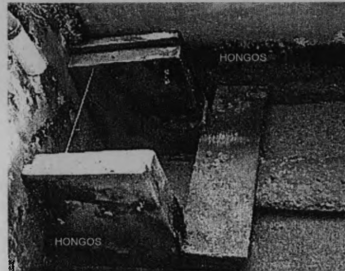
Fotografía 91. FALTA DE MANTENIMIENTO PRODUCE HONGOS.
