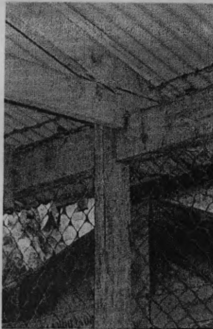
Fotografía 102. MANCHAS EN ESTRUCTURA DE MADERA
