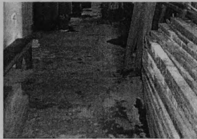
Fotografía 56. MANCHAS POR HUMEDAD, DESPRENDIMIENTO EN COLUMNA, FALTA DE MANTENIMIENTO
