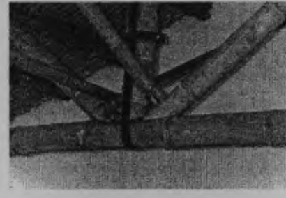
Fotografía 142. DETALLE DE SUJECION ENTRE TIRANTES, PUNTAL Y VIGA INFERIOR DE LA TIJERA
