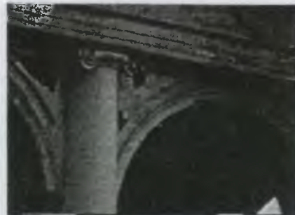
Desprendimiento de acabados (pintura y repello) y de elementos decorativos en muros exteriores.
