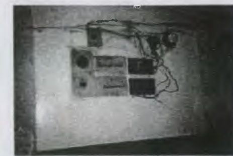
Sistema eléctrico, el cual tiene los cables expuestos, pudiendo causar daño al edificio.
