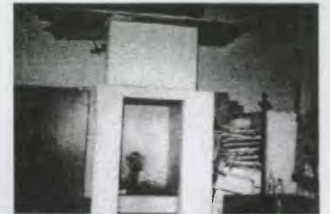
Estado de abandono en la que se encuentra el servicio sanitario.
