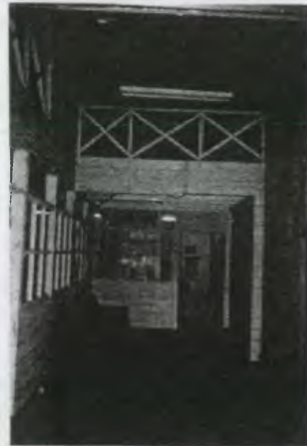
Se observa el entrepiso agregado por la falta de espacio, el cual sobrecarga la estructura del edificio.
