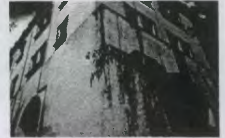
Contrafuerte con presencia de vegetación.
