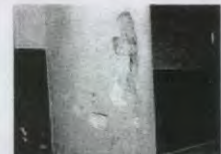
Desprendimiento de material en las columnas principales del edificio.
