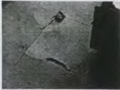
Se observan el piso del interior quebrado.
