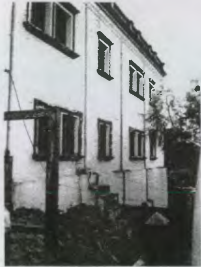
Fachada poniente, se observa la vegetación aledaña que incrementa la humedad en los muros.
