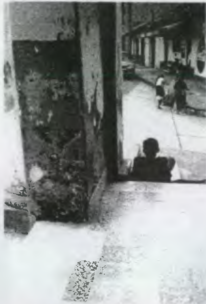
Columna con intervenciones de concreto y en donde se observan las diferentes capas de pintura aplicadas al edificio.
