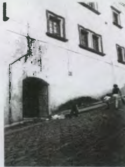
Fachada oriente con desprendimiento de material.
