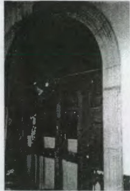
Puerta principal del edificio, la cual ya fue cambiada debido al estado en que se encontraba.
