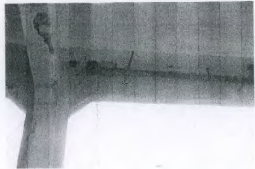
oxidación de vigas y columnas salida de drenaje (fotografía 24)
