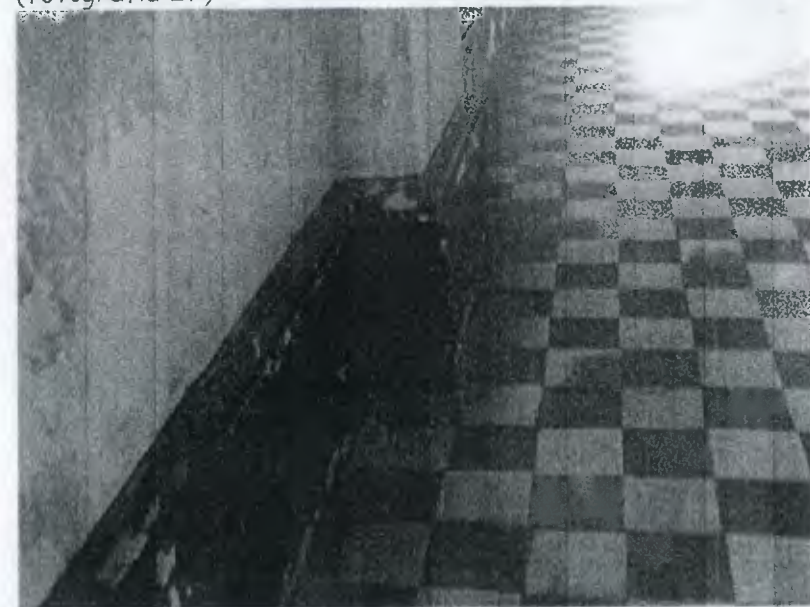
El zócalo presenta signos de pulverulencia, hongo y sales al igual que los muros (fotografía 29)
