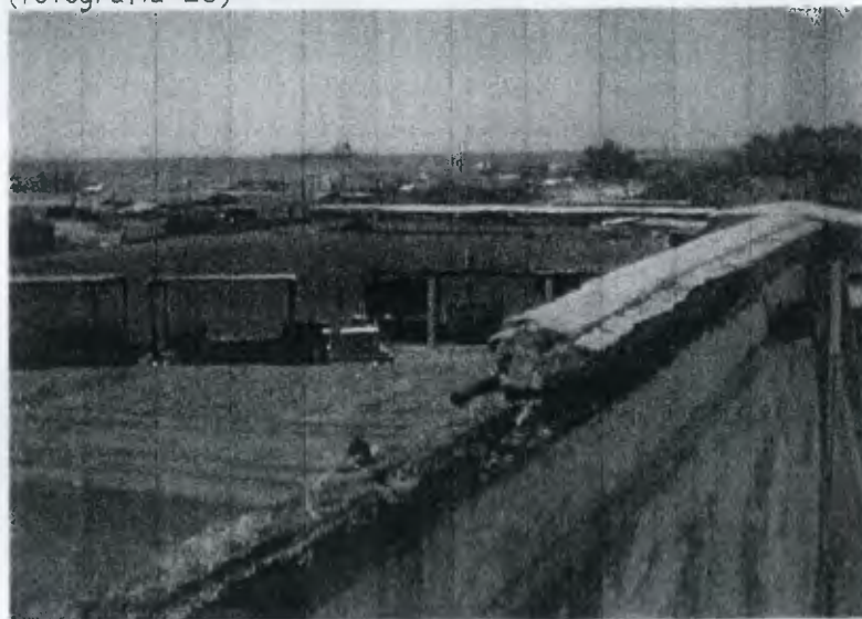
Orilla de pasamanos faltante (fotografía) (fotografía 28)
