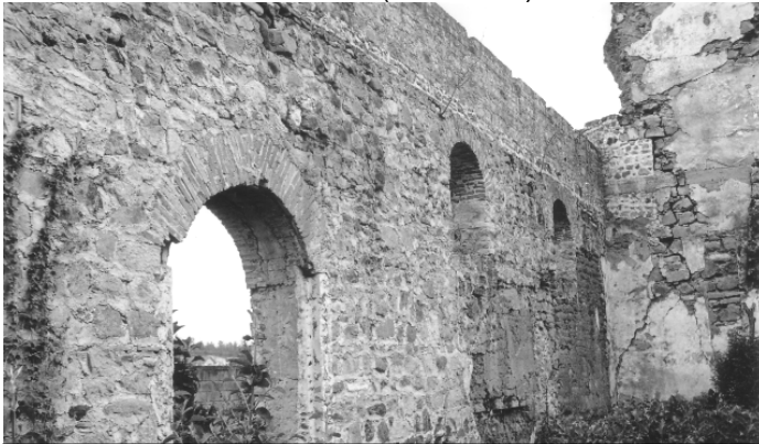
Fotografía No.10 Muro lateral sur ( alteración)
