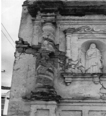
Fotografía No.3 Deterioro de la Fachada Detalle de columna Serpentinada
