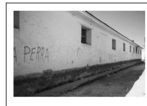
Fotografía N° 28 Graffiti en muros norte.
