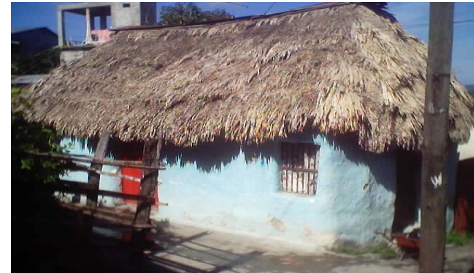
Foto 60 Actual estado de la Vivienda vernácula ubicada en el Barrio El Remolino
