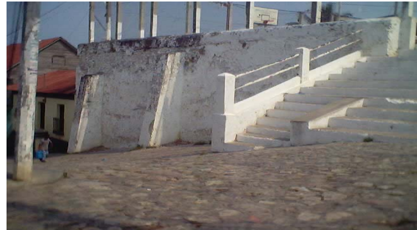
Foto 63 Estado actual de la muralla antigua
