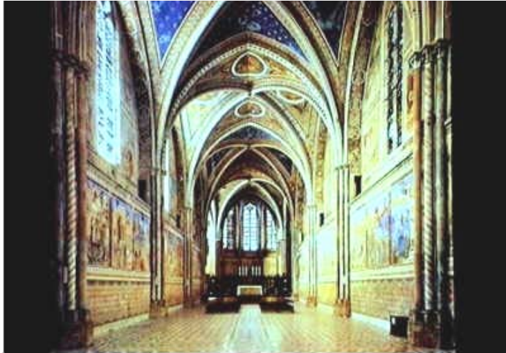
▲ Imagen 31: Aspecto interior de la Basílica de San Francisco construida en 1228 y dañada extensamente por los terremotos de 1997 en Asís, Italia.
