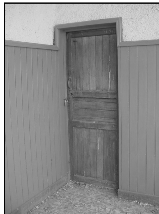
PUERTAS DE INGRESO A LAS CABINAS DE CONTROL
