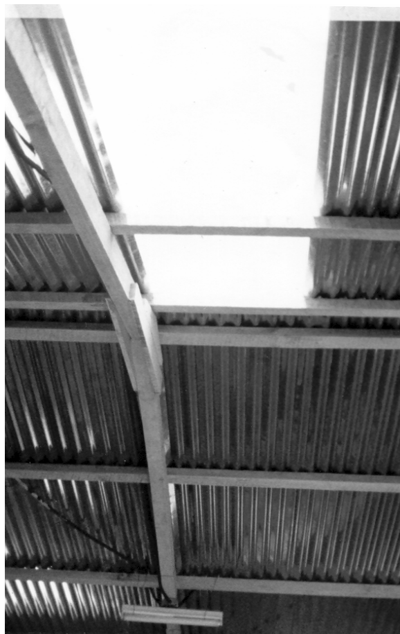
▲ Vista Interior del Techo (Instalaciones Eléctricas e Iluminación, Concepción Las Lomas.
