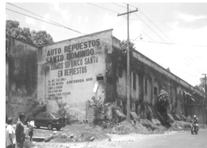
Fotografía #1 Vista sobre fachada SUR, se observa humedad y crecimiento de vegetación y hongos sobre los muros.
