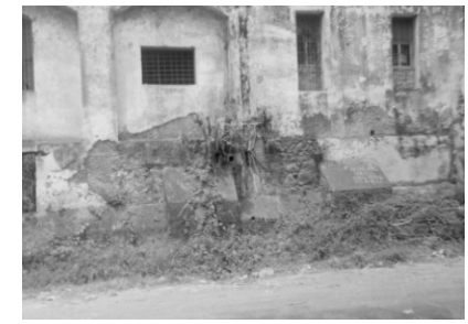
Fotografía #2 Vista sobre fachada SUR, se observan desprendimiento y pérdida parcial de contrafuerte.
