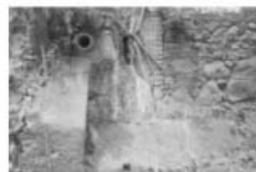
Fotografía #59. Se puede observar crecimiento de plantas alrededor de una bajada de agua, y materiales expuestos.
