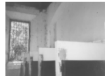
Fotografía #70. Instalación de puertas dañando muros, y sin reparación.
