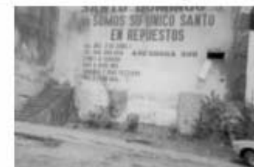
Fotografía #60. Observe el uso de uno de los muros posteriores, con publicidad, y el exceso de humedad del muro.
