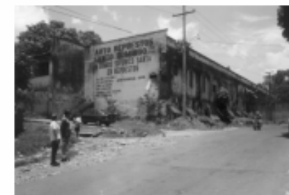
Fotografía # 31. Podemos observar el ingreso a la morgue y el deterioro que sufre actualmente la escuela. (Vista posterior)
