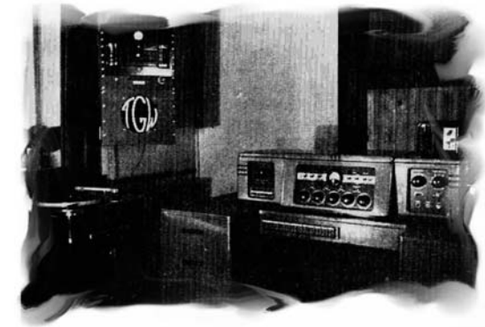
Fotografía No. 44 CUARTO DE CONTROL II
