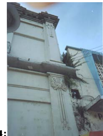
Fotografía No. 34: Fachada frontal en la parte colindante empiezan a crecer plantas, porque existe un espacio entre ambos, y estas se colocan sobre el muro.
