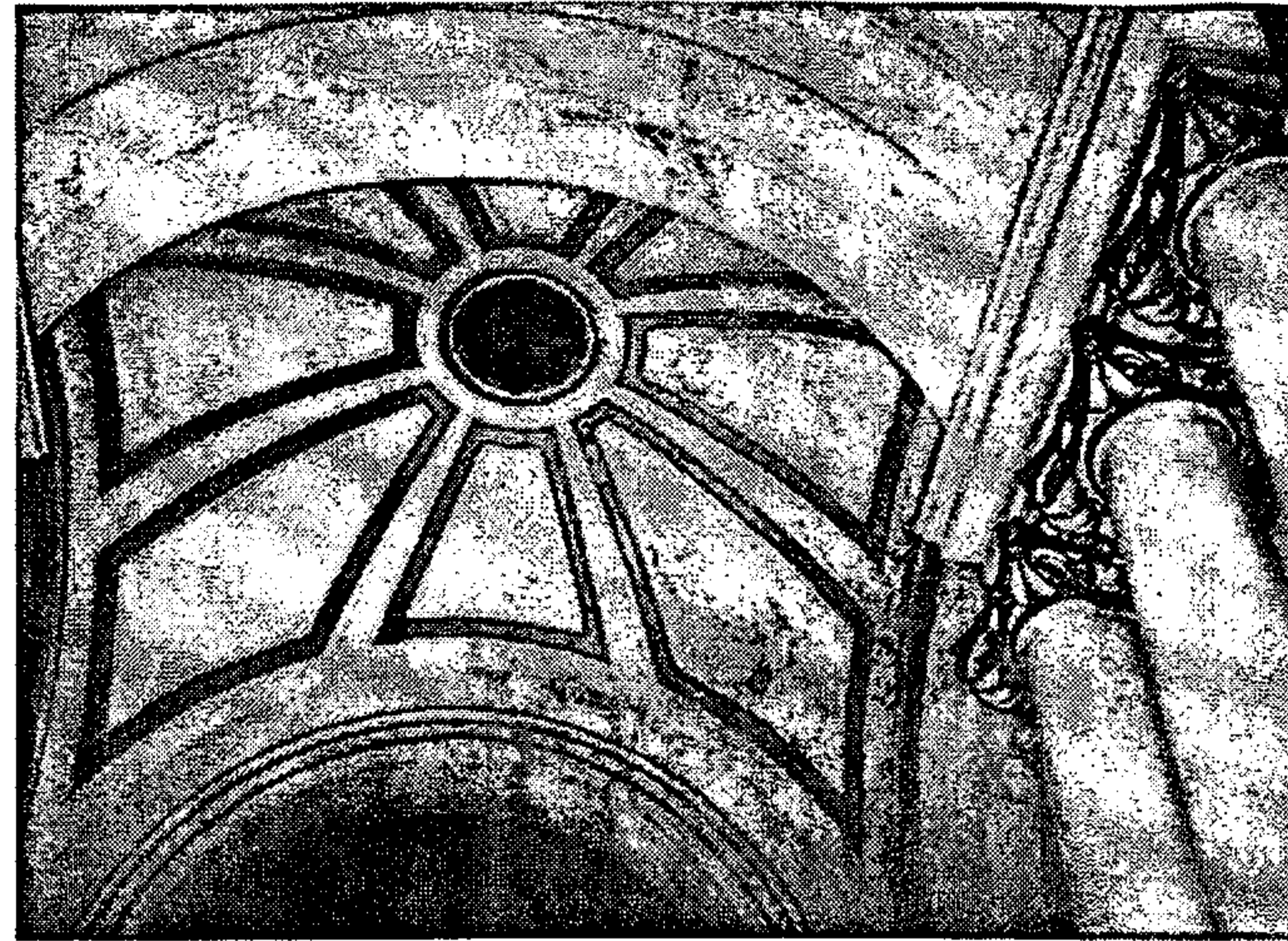
Fotografía No. 112: bóveda de la capilla En el cielo de la bóveda del techo de las capillas, se evidencia la saturación de humedad a través de microflora y de manchas de humedad.
