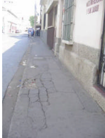
Fotografía 2. 10 calle entre 12 y 13 avenidas. Banquetas de concreto rajadas. Es evidente el deterioro a lo largo de la calle.
