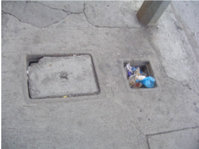
Fotografía 16. Deterioro en tapaderas de caja de agua, la falta de estas provoca que se conviertan en basureros o acumulen basura dentro de ellas a causa del viento. 10 calle entre 12 y 13 avenida. Autor David Rosales, 2003.
