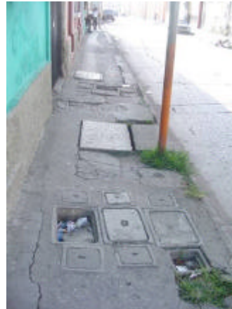
Fotografía 4. 10 calle entre 12 y 13 avenidas. faltan tapaderas de cajas provoca deterioro de la acera y basureros además de obstáculos en la vía peatonal.
