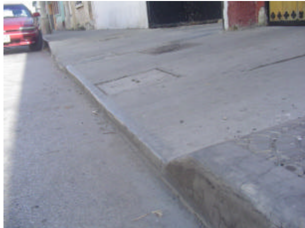
Fotografía 11. 11 calle acera norte entre 11 y 12 avenidas. Este muestra un vado vehicular mejor realizado con una pendiente tendida.
