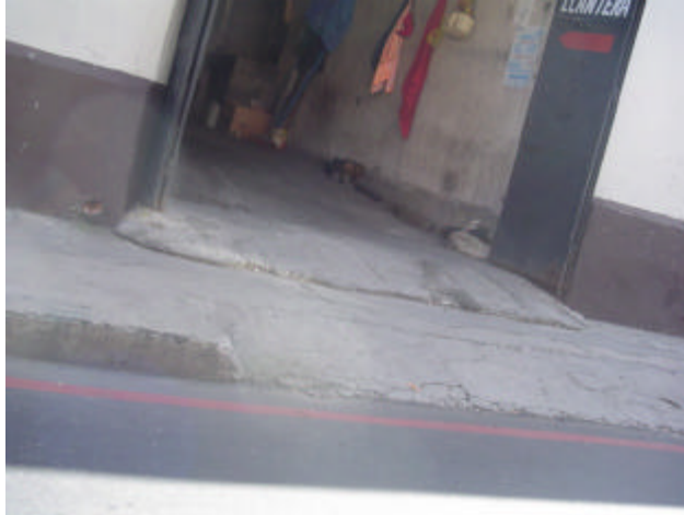
Fotografía 10. 12 calle inmueble de esquina entre la 12 y 11 avenidas. Muestra el estado actual de algunos de los vados vehiculares dentro del núcleo los cuales presentan obstáculos en la zona de circulación peatonal.
