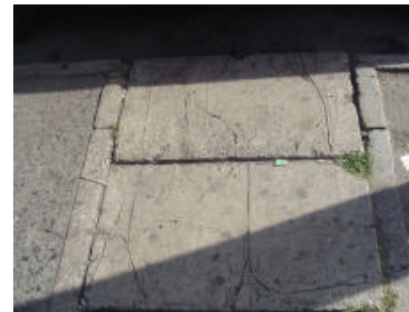
Fotografía 7. 10 calle entre 11 y 12 ave. Tapaderas deterioradas y rajadas la utilización de 2 piezas para tapar las mismas provoca acumulación de basura y crecimiento de hierbas en sus uniones.
