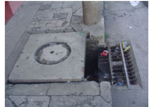
Fotografía 20. Tragante de tapadera redonda de concreto y base cuadrada mas rejilla de acero, se puede observar las rajaduras en aceras y tapaderas, así como la falta de basureros en las calles. 12 calle. Autor David Rosales, 2003.
