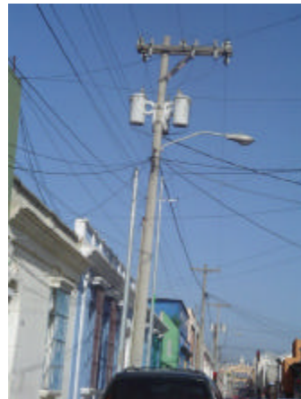
Fotografía 24. Poste de concreto con transformador y luminaria. La gran cantidad de líneas provoca deterioro de la imagen urbana. 12 calle. Autor David Rosales, 2003.
