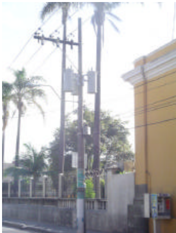
Fotografía 23. Poste de concreto con transformadores. Se hace evidente la contaminación de la imagen urbana debido a la cantidad de líneas. 12 avenida. Autor David Rosales, 2003.
