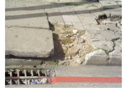
Fotografía 8. 12 Calle entre 11 y 12 ave. Bordillos escindidos provocan deterioro de aceras y tapaderas lo cual obstaculiza el paso peatonal.
