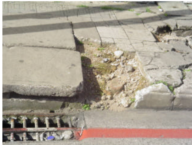
Fotografía 18. Deterioro de bordillo y aceras a causa de las tapaderas (2 rectangulares) de los tragantes provoca obstáculo para los peatones. Rejilla de acero. 11 calle Autor David Rosales, 2003.
