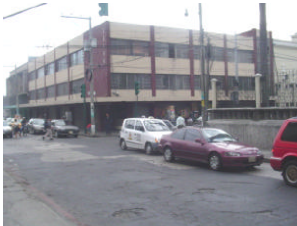
Fotografía 14. Pavimento deteriorado 12 avenida. El deterioro del pavimento es evidente y provoca embotellamientos en un solo carril debido a que los pilotos prefieren circular por el carril de superficie más homogénea para no dañar los vehículos. Autor: David Rosales. Agosto 2003.
