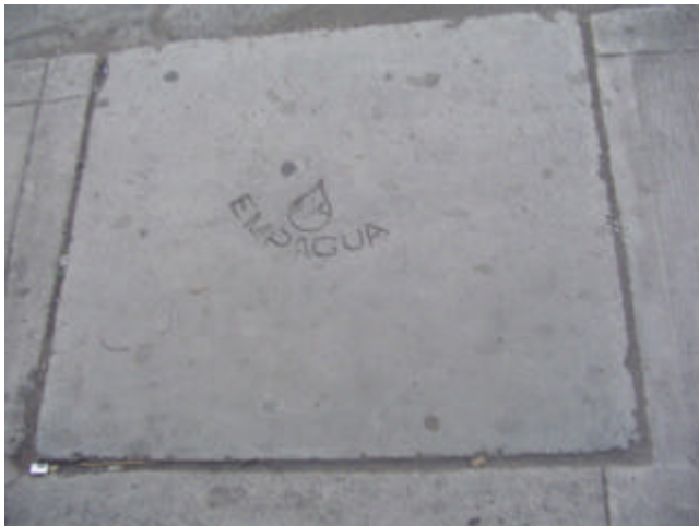
Fotografía 17. tapadera de caja de llaves de control. Esta no representa obstáculo ni riesgo para la seguridad del peaton pero se encuentra deteriorada en sus aristas. 11 calle. Autor David Rosales, 2003.
