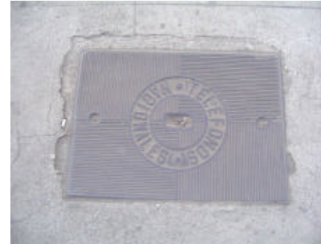
Fotografía 30. Tapadera caja telefónica subterránea. 11 calle. Autor David Rosales, 2003.
