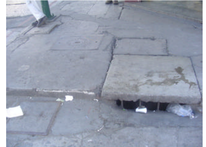
Fotografía 19. Tragante de tapadera cuadrada de concreto rejilla de varillas de acero fundidas para evitar la entrada de basura y taponamientos posteriores, evidencia falta de basureros. 10 calles esquina 12 avenida. Autor David Rosales, 2003.
