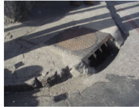
Fotografía 6. Esquina 12 avenida y 10 calle. Bordillo escindido por la humedad y los golpes de vehículos. Tragante en esquina con tapadera de acero y rejilla con dientes.
