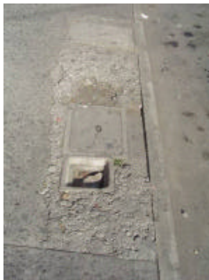
Fotografía 3. 11 calle entre 11 y 12 av. La falta tapaderas de cajas de agua provoca el deterioro de las mismas ya que estas se convierten en basureros y obstáculos para el peatón.
