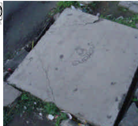
Esta es una tapadera de una caja de registro de concreto. La misma presenta grietas, y se puede observar el deterioro de la banqueta que la rodea.
