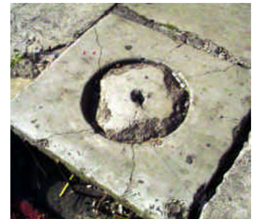
Véase el deterioro que presentan las tapadera de concreto: grietas, desprendimiento de partes.
