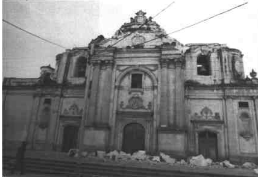
Fotografía No. 7. Iglesia La Merced. Daños por terremoto 1976.
