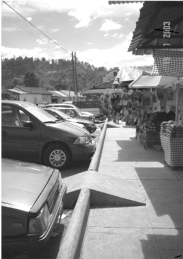
Foto 3. Se pueden observar los problemas de drenaje pluvial que presenta el lugar, por ello fue necesario construir este muro bajo.
