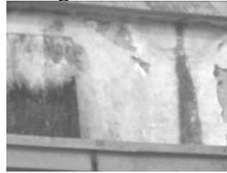
- Presencia de manchas
