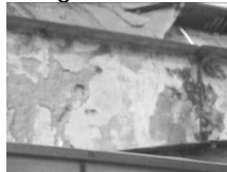
- Presencia de humedad en muros
