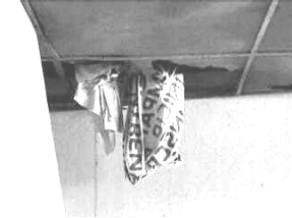
- Deterioro en techo, presencia de elementos agregados
