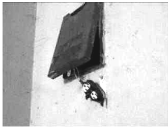
- Instalación expuesta de alambres de caja eléctrica
