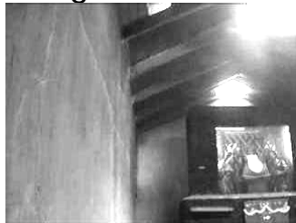
- Deterioro en muros
