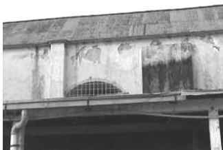
Deterioro en laminas
