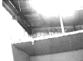
- Deterioro en muros, techo, y lamina
