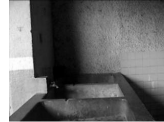
- Presencia de manchas
