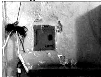
- Transformación distributiva debido a elementos agregados, como cajas de electricidad y deterioro en muro
