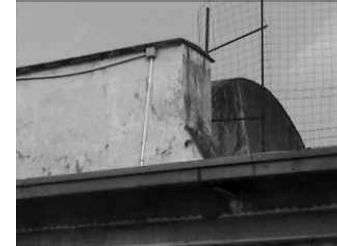
- Deterioro por el impacto
