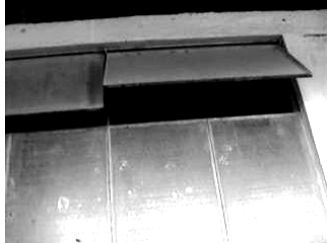
- Manchas en ventanas
