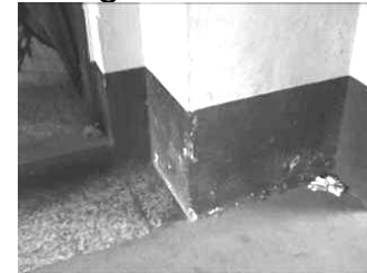
- Manchas en muros y cambio de piso
