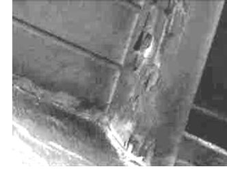
- Deterioro en vigas
