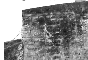
- Presencia de manchas y deterioro en muros
