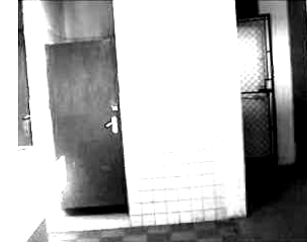
- Deterioro por el uso excesivo e impacto
