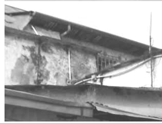
- Deterioro de muros por hongos y humedad
