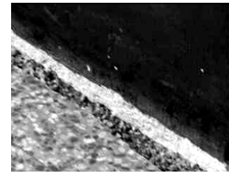
- Grieta entre muro y piso
