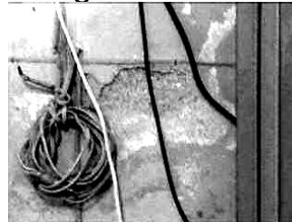
- Cables expuestos y deterioro en muro
