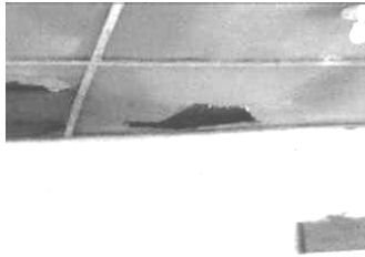
- Deterioro en techo
