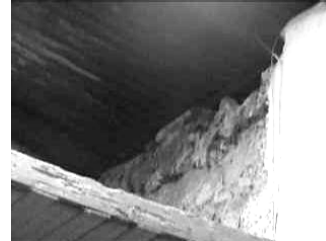
- Deterioro en muros
