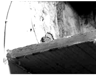
- Deterioro del machihembre
