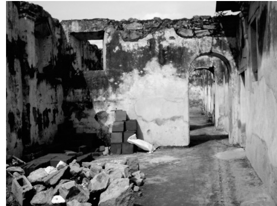
FOTO NO. 38 Interior Monumento puede observarse el deterioro por agentes naturales
