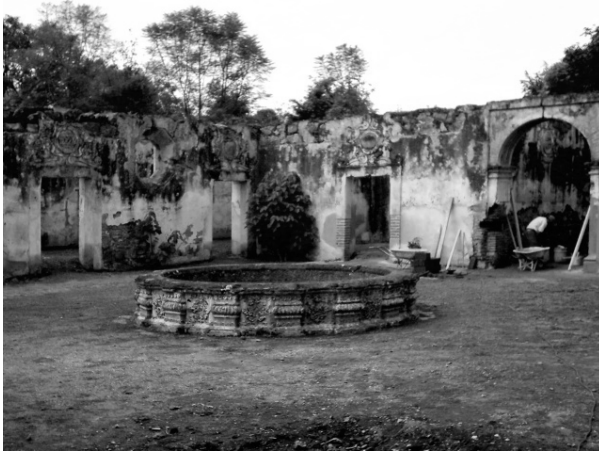
FOTO NO. 40: Patio Principal Puede verse el deterioro de los muros
