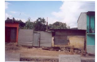
Fotografía No. 6 Vista al Este del templo fachada de lámina de zinc con muro de adobe muy deteriorado.
