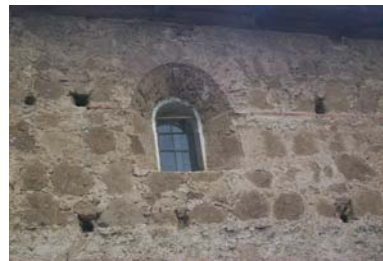
Fotografía No.68 desprendimiento total de material en repello de muro de fachada lateral derecha.
