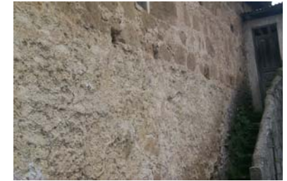
Fotografía No.70 Desprendimiento de material en repello de entrada a los campanarios.
