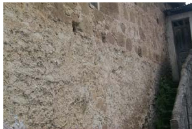
Fotografía No.67 Desprendimiento total de material en repello de muro de fachada lateral izquierda.
