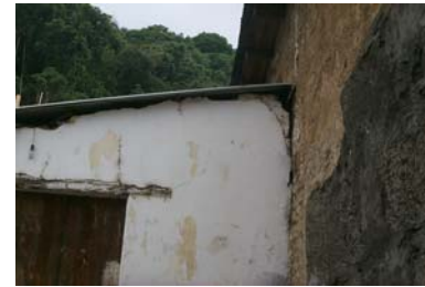
Fotografía No.69 Desprendimiento de material en repello de fachada lateral izquierda.
