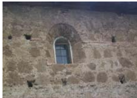
Fotografía No. 60 Vista exterior de ventana de Muro lateral del templo.
