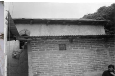
Fotografía No.72 Desprendimiento de material en repello de muro de fachada lateral derecha.
