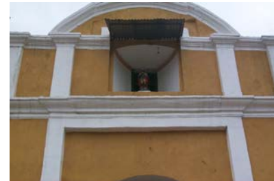
Fotografía No. 65 Vista de pared frontal exterior dañada por humedad
