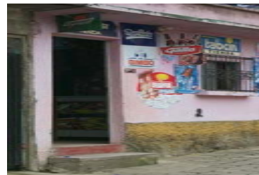
Fotografía No.22 Fachada de vivienda-comercio de de block y lámina de zinc actualmente en proceso de construcción.
