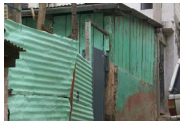
Fotografía No.21 Fachada Vivienda de lámina de zinc, madera y muro de adobe muy deteriorado.
