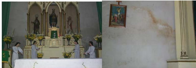
Fotografía No.61 Vista de pared posterior del templo detrás del altar mayor dañada
