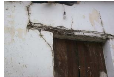
Fotografía No.71 Grieta en fachada frontal de la anterior sacristía del templo.
