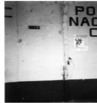
FOTOGRAFIA No 23 Deterioro. plaga en elemento estructural de madera
