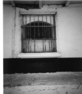
FOTOGRAFIA No 11 Alteracion: Tapiado parcial de ventana, deterioro de balcón
