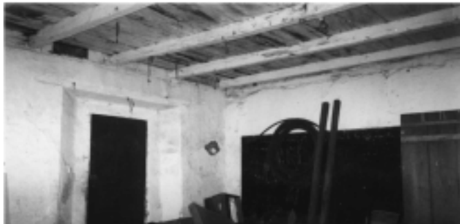
FOTOGRAFIA No 19 DETERIORO: Presencia de humedad en muros cielos y pisos.
