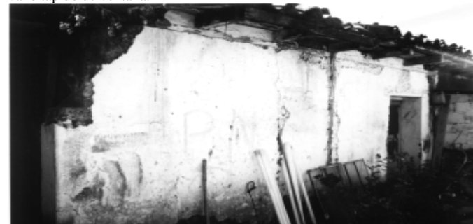
FOTOGRAFIA No 21 DETERIORO: Derrumbe de muros y techo del edificio.
