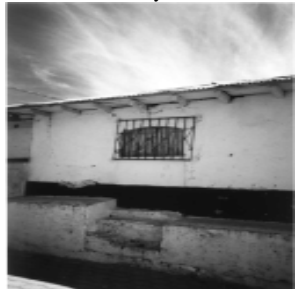
FOTOGRAFIA No 8 Alteración: Vano tapiado de puerta, con balcón metálico.
