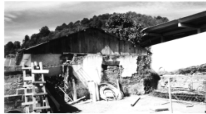
FOTOGRAFIA No 22 Deterioro: Perdida de acabado en muro exterior, macro flora en muro de adobe. Y vano tapido de ventana.
