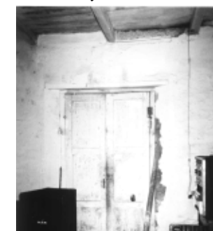
FOTOGRAFIA No Deterioro: Desportillado de acabado en muro
