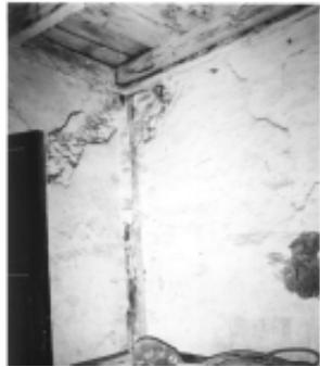
FOTOGRAFIA No 4 Deterioro: Fisuras, en muro y humedad.
