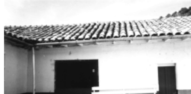
FOTOGRAFIA No 17 Alteración: Vano mas amplio con puerta metálica.
