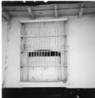
FOTOGRAFIA No 10 Alteración Vano tapiado y deterioro balcón de madera.
