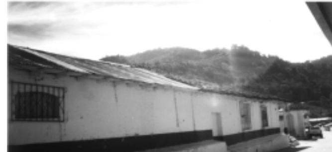
FOTOGRAFIA No 15 Alteración: Lámina de zinc en sustitución de teja de barro cocido.
