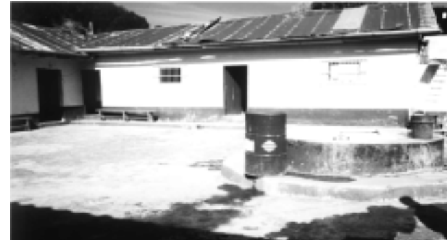
FOTOGRAFIA No 16 ALTERACION: Lámina de Zinc en sustitución de teja de barro cocido
