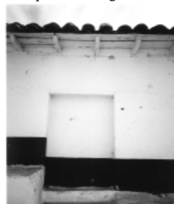
FOTOGRAFIA No 9 Alteración: Tapiado en vano de puerta da a la calle.
