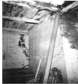
FOTOGRAFIA No 7 Deterioro: derrumbe que tienen algunos muros.
