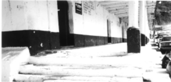
FOTOGRAFIA No 1 Deterioro: Desportillado de gradas
