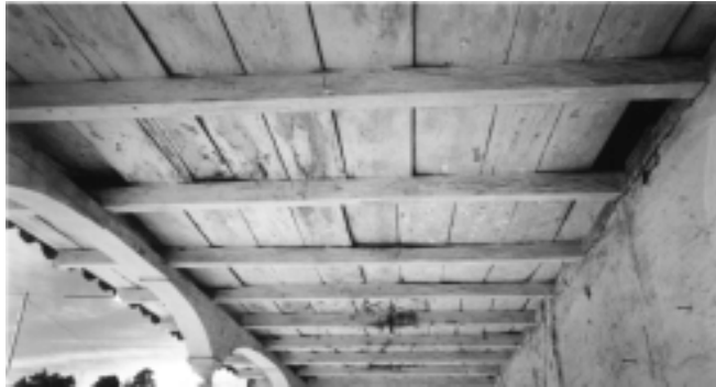
FOTOGRAFIA No 18 DETERIORO: Humedad de cielo falso, presencia de micro flora.
