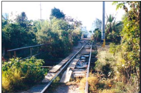
FOTO 13: puente Morán en total destrucción, cercano a la estación, (Fotografía b).
