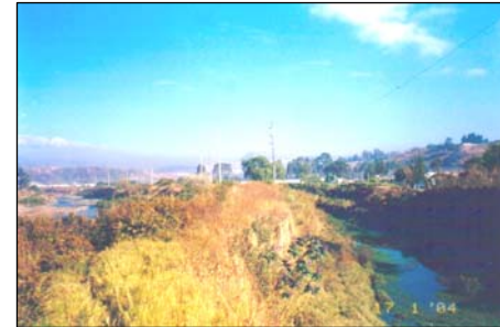
FOTO 17: fin del tramo con rieles, únicamente continúa posteo eléctrico. Gran parte erosionada por el río, (Fotografía d2).
