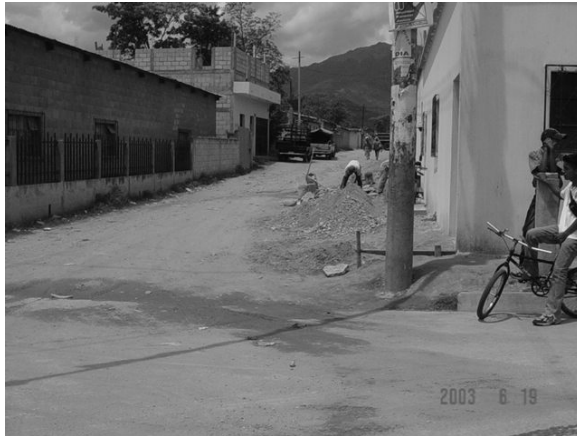
FOTO 14: Se observa uno de los postes de alumbrado eléctrico. En ese momento, trabajadores de la municipalidad de Rabinal estaban realizando la instalación de drenajes.
