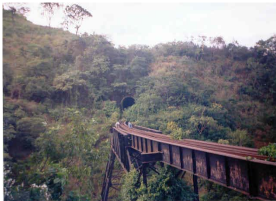
Foto No. 35 El puente de La Cuesta y el túnel No. 6 donde se aprecia la ausencia de durmientes sobre el puente. Fuente: José Manuel Sanabria. Noviembre 2003.
