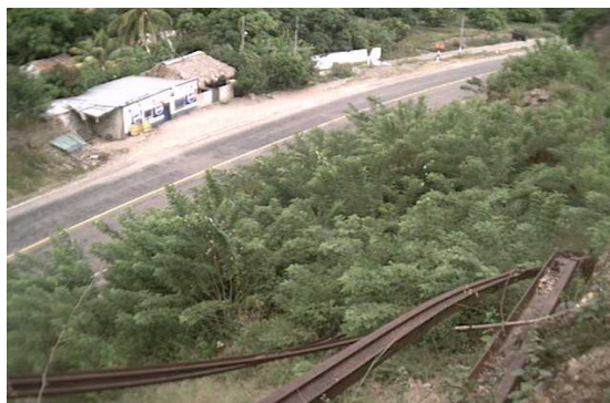
Foto. No. 28 Rieles suspendidos en el aire, a consecuencia de los derrumbes, en la estación La Arada. Fuente: José Manuel Sanabria. Noviembre 2004.
