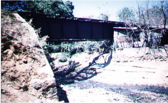
Foto No. 18 Puente del ferrocarril sobre el Río Tacó en la Ciudad de Chiquimula. Donde se aprecia una vivienda construida de lámina casi debajo del puente y la contaminación del río Tacó. Fuente: José Manuel Sanabria. Febrero 2004.
