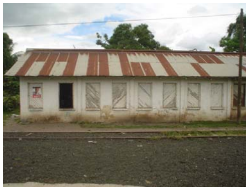
Foto 59. Fachada Oriente Yarda de Peones 13 Módulos, en la Estación Ipala fuente: César Mota, año 2003.
