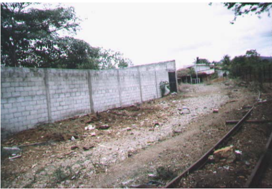
Foto 28. Carencia de durmientes en la Yee de la Estación de Ipala Fuente: Silvia Rosales, Mayo 2004.
