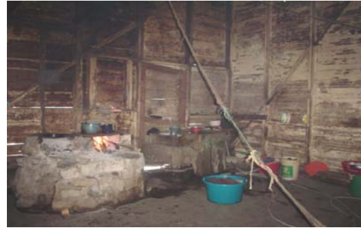
Foto 34. Deterioro interno en paredes Estación Ipala, fuente: Silvia Rosales, Octubre 2003.
