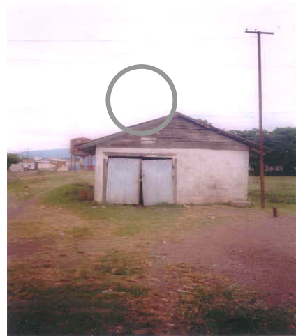
Foto 43. Fachada Sur, el portón de lámina se encuentra caído en Taller de Mantenimiento, Estación Ipala. Fuente: Silvia Rosales, Octubre 2003.
