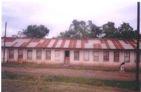
Foto 55. Fachada Oriente, las puertas son modificaciones de ventanas hechas por los habitantes de la Yarda. Fuente: César Mota, Octubre 2003.
