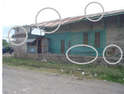
Foto 36. El sistema constructivo sufre de daños visibles en el exterior, fuente: Silvia Rosales, Octubre 2003.
