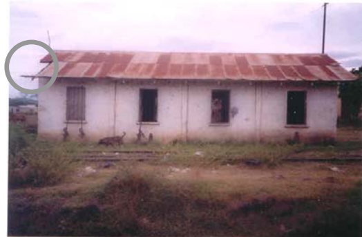
Foto 44. Fachada Oeste, faltante de lámina en el techo del Taller de Mantenimiento, Estación Ipala. Fuente: Silvia Rosales, Octubre 2003.
