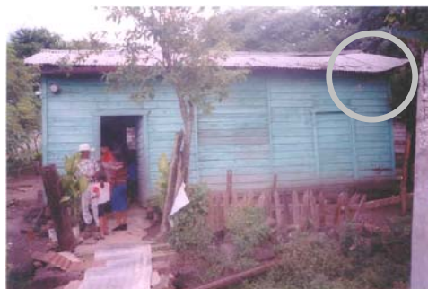
Foto 38. Fachada principal Oeste. Techo desplomado en Casa del Agente, Estación Ipala, fuente: César Mota, Octubre 2003.
