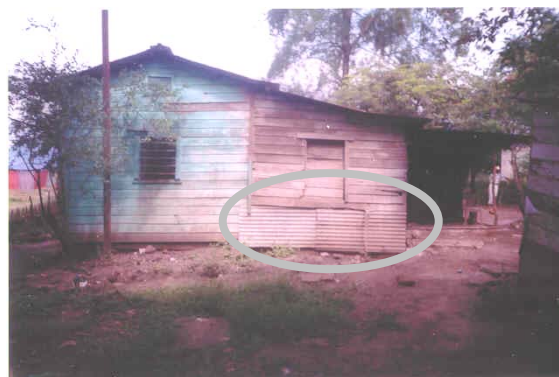
Foto 40. Fachada Sur, sistema constructivo en mal estado, por la falta de duelas de madera se han colocado láminas de zinc. Fuente: César Mota, Octubre 2003.
