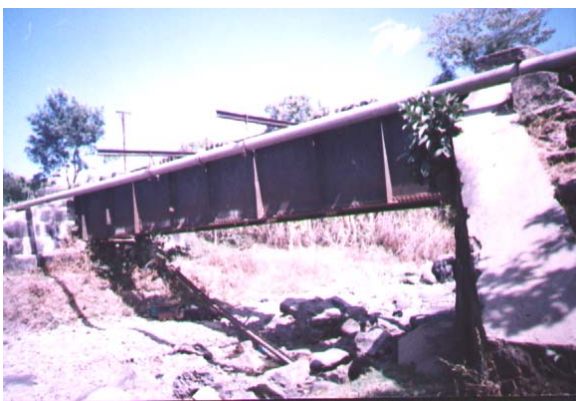
Foto 60. Puente cerca de la Estación de Ipala sufriendo deterioro producido por las inclemencias del tiempo fuente: César Mota, Febrero 2004.
