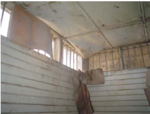
Foto 33. Deterioro interno en cielo suspendido Estación de Ipala, fuente: César Mota, Octubre 2004.
