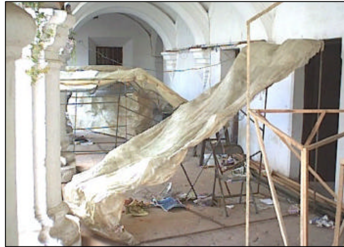
FOTOGRAFIA No. 8: Al ser colocada la estructura del andamiaje en los corredores, se hace muy difícil la circulación, además que la baldosa se ha ido dañando. Claustro Escuela de Cristo, La Antigua Guatemala
