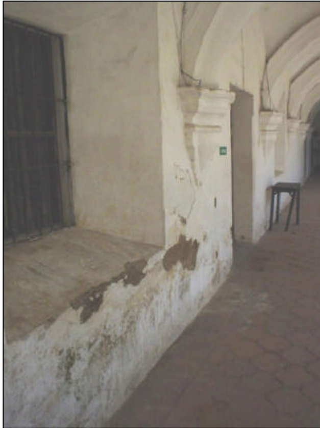
FOTOGRAFIA No. 11: Debido a los agentes extrínsecos, el sillar ha sufrido de erosión, sumándole la humedad. Claustro Escuela de Cristo, La Antigua Guatemala
