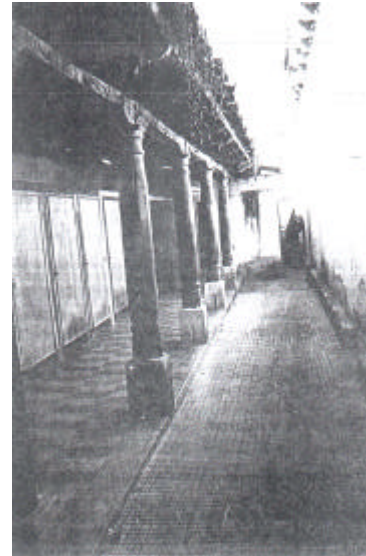
Fotografía No. 5: Muestra los sanitarios, y el mal estado en que se encuentran. Fuente: CNPAG
