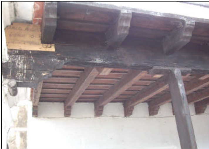
FOTOGRAFIA No. 25: Debido a la falta de mantenimiento, y falta de conocimiento se han incrustado objetos que no van de acuerdo a la tipología de la misma.
