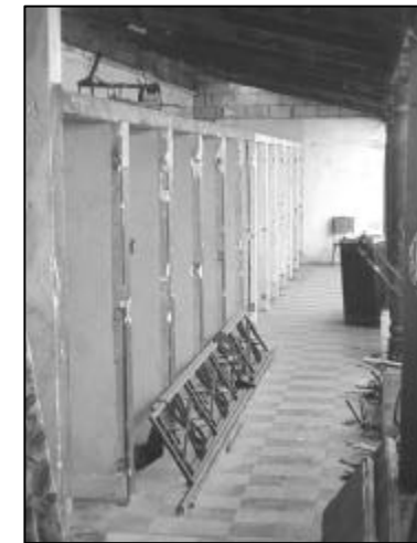
FOTOGRAFIA No. 42-b: En total abandono y deteriorados se encuentra el sector donde están los servicios sanitarios, sector sur. Claustro Escuela de Cristo, La Antigua Guatemala
