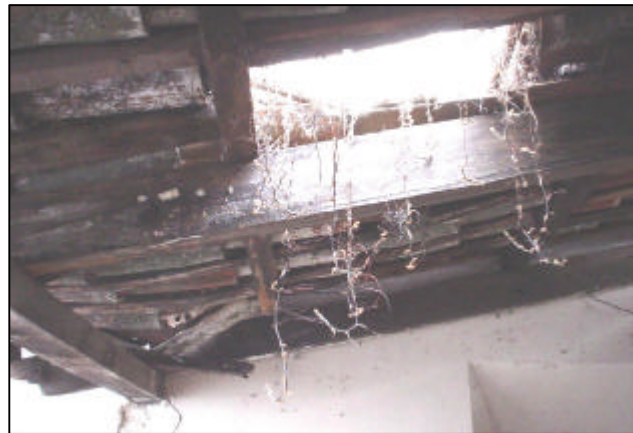
FOTOGRAFIA No. 41: La cubierta podría colapsar, por lo que es necesario removerla y evitar un accidente en el futuro. Claustro Escuela de Cristo, La Antigua Guatemala
