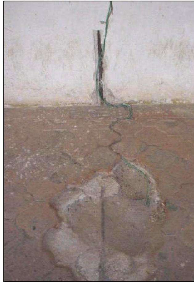
FOTOGRAFIA No. 16: Debido a la erosión existente en el piso pueden verse en algunas áreas, las instalaciones, como lo muestra esta fotografía. Claustro Escuela de Cristo, La Antigua Guatemala
