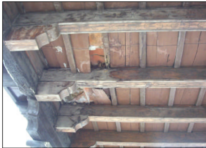
FOTOGRAFIA No. 30: Se puede ver el mal estado en que se encuentra la madera, esta necesita ser cambiada en su mayoría, para evitar que colapse. Claustro Escuela de Cristo, La Antigua Guatemala
