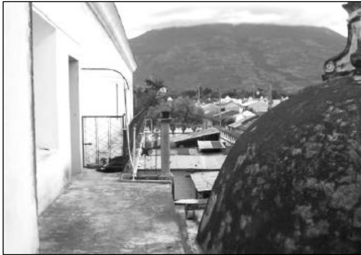
FOTOGRAFIA No. 27: Vista hacia el lado oeste del convento, Cúpula del paso incrustado en la fachada del convento. Claustro Escuela de Cristo, La Antigua Guatemala
