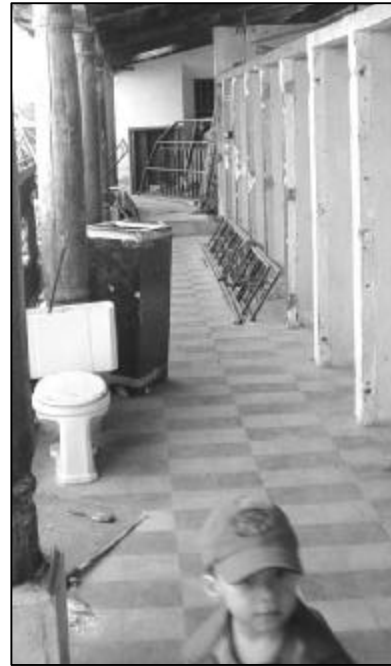
FOTOGRAFIA No. 42: No sólo la cubierta se encuentra dañada, también las pilastras que su función es soportar el peso de la cubierta. Claustro Escuela de Cristo, La Antigua Guatemala
