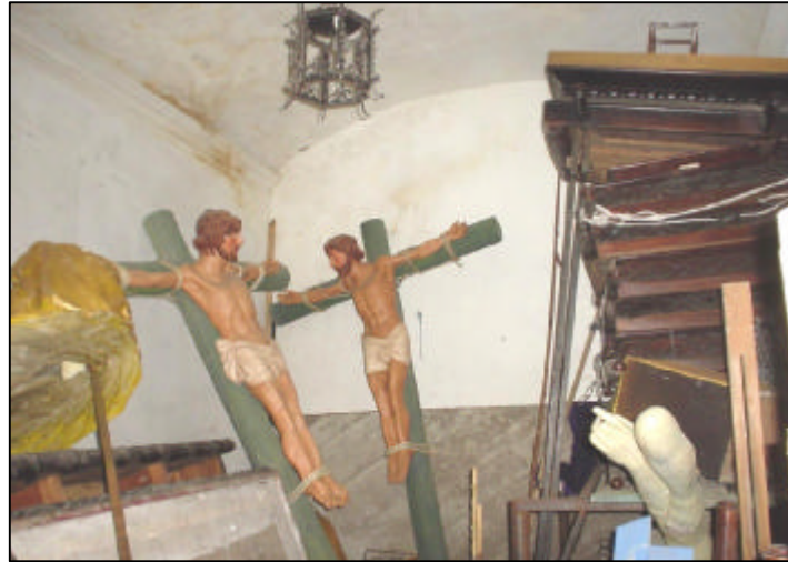
FOTOGRAFIA No. 12: Foto tomada del interior de un pasillo. Se ve la humedad existente. Claustro Escuela de Cristo, La Antigua Guatemala
