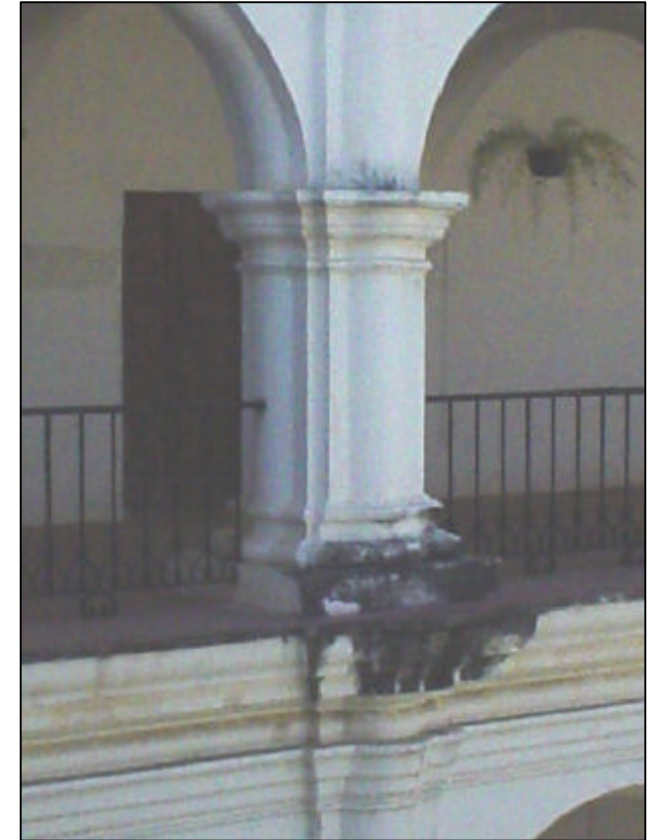
FOTOGRAFIA No. 14: Puede verse la humedad, en la columna ubicada en el segundo nivel. Claustro Escuela de Cristo, La Antigua Guatemala
