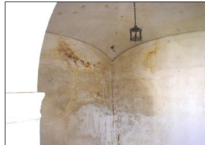
FOTOGRAFIA No. 20: La cubierta de las gradas, es un bóveda vahida, y puede verse la humedad que la afecta. Claustro Escuela de Cristo, La Antigua Guatemala
