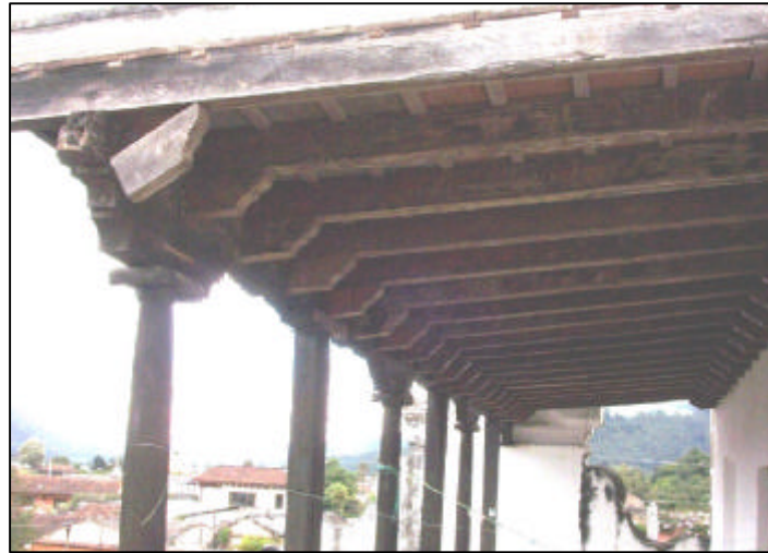
FOTOGRAFIA No. 24: Es notable el daño, en la terraza española, la cual sirve de cubierta al ambiente exterior, del dormitorio del sacerdote que ahí reside.
