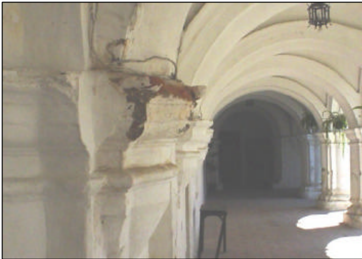
FOTOGRAFIA No. 13: Detalle de remate de arcos, se puede ver que algunos han sufrido desprendimiento, erosión, y falta de mantenimiento. Claustro Escuela de Cristo, La Antigua Guatemala
