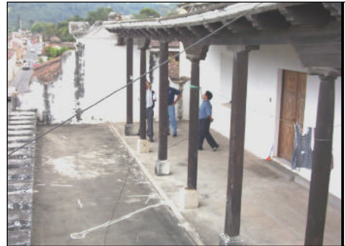
FOTOGRAFIA No. 26: Desde este ángulo se observa el flambeo que afecta a la terraza española.
