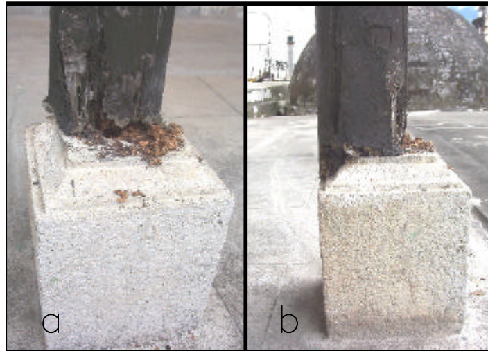
FOTOGRAFIA No. 28: Vista frontal de la base de la columna de la terraza española (foto "a") y la vista lateral (foto "b"), muestra el desfase que hay debido al peso de la terraza española que ejerce sobre la columna de madera. Claustro Escuela de Cristo, La Antigua Guatemala
