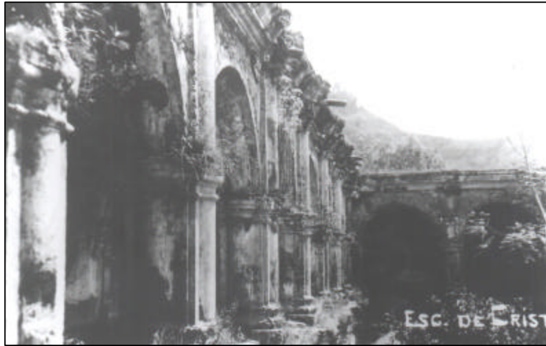
FOTOGRAFIA No. 6: (1940 aprox.) El mal estado y abandono hizo imposible que este convento fuera habilitado, son notables los daños en arcos y columnas. Claustro Escuela de Cristo, La Antigua Guatemala
