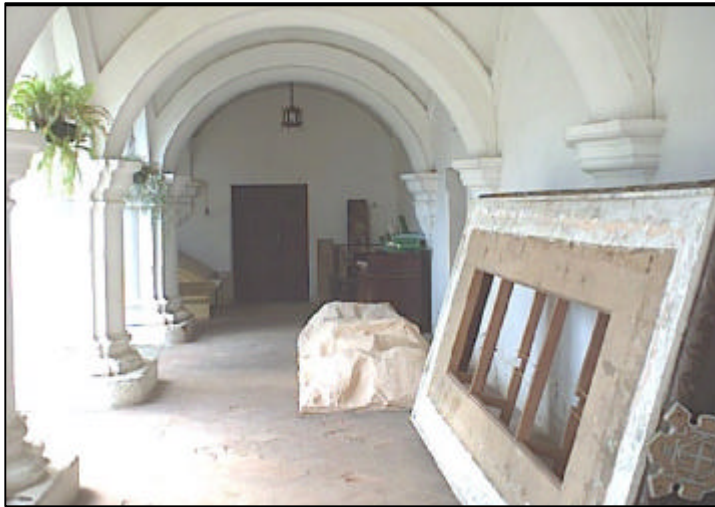
FOTOGRAFIA No. 7: Como se muestra en esta fotografía, el andamiaje está apoyado en el muro, sin ninguna protección hacia el monumento, para evitar sea dañado. Claustro Escuela de Cristo, La Antigua Guatemala
