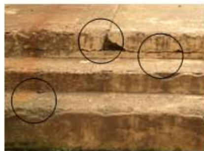
Foto No. 26 Fracturas y disgregación en las gradas, presencia de humedad, y desgaste en acabado final (cemento líquido y revestimiento de pintura).
