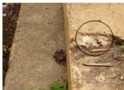
Foto No. 44 Fisuras y disgregaciones en gradas y pisos, presencia de polvo, humedad y flora.
