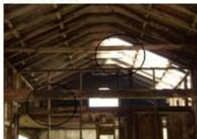
Foto No. 41 Faltantes de elementos en la cubierta (lámina) y elementos de cerramiento horizontal (tabiques interiores de madera) desprendimiento de pintura en muros interiores.
