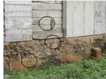
Foto No. 23 Instalaciones expuestas, faltantes y erosión de los cimientos, desprendimiento de acabados en los mismos y de elementos adosados en muros, presencia de humedad, hongos y flora.
