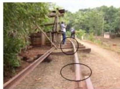
Foto No. 30 Faltantes y oxidación en todo el sistema férreo a lo largo de la línea del tren, (rieles, durmientes, clavos, platinas), Invasiones temporales como puestos de venta en desuso.
