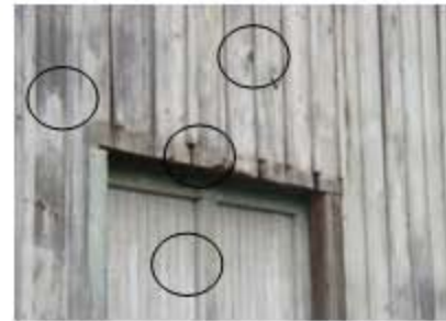
Foto No. 24 Fisuras y faltantes de marcos y fracturas provocadas en dinteles de puertas por desprendimiento de los mismos, decoloración y exfoliaciones en pintura.
