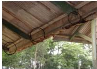
Foto No. 21 Presencia de oxidación, desprendimiento de la pintura, canaletas picadas producto de la oxidación y pérdida total de las tuberías de las bajadas de aguas pluviales.
