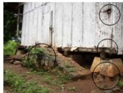
Foto No. 34 Fracturas y disgregación en las rampas de acceso, presencia de humedad, flora y desgaste en acabado final en ci-mientos (cemento líquido y revestimiento de pintura).
