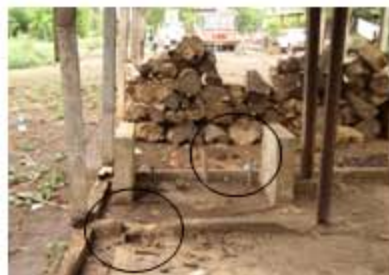
Foto No. 45 Instalaciones de expuestas, pérdida de elementos verticales (columnas y muros), fracturas en cimientos corridos, presencia de humedad, flora e invasión del corredor para colocación de leña.
