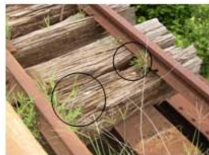
Foto No. 29 Putrimiento de durmientes a lo largo de la línea férrea, faltantes de elementos, ( rieles, durmientes, clavos, platinas) presencia de oxidación, flora y humedad.
