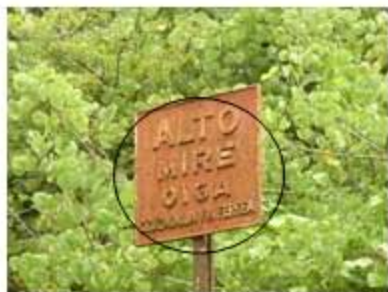
Foto No. 33 Oxidación y pérdida del revestimiento de pintura en elementos complementarios, como la señalización a lo largo de la línea férrea.
