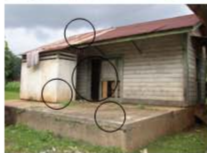
Foto No. 27 Oxidación en cubiertas (láminas), faltantes en cerramiento horizontal, fracturas y disgregación en los cimientos, pisos figurados y presencia de flora en los mismos.
