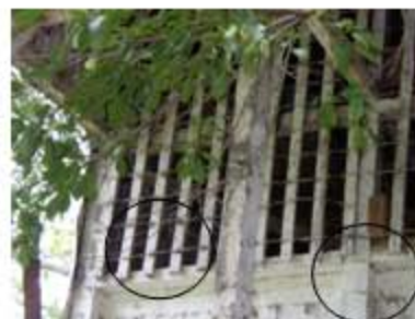
Foto No. 36 Desprendimiento de pintura en muros, presencia de humedad, polvo, telarañas, insectos; pudrimiento y destrucción de la madera por factores mencionados anteriormente.
