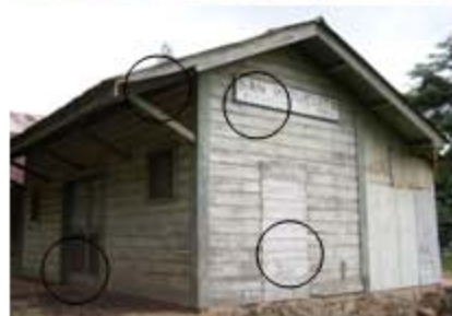
Foto No. 28 Faltantes de elementos de carga horizontal (vigas de madera), decoloración de muros y exfoliación en pintura de elemento de identificación.
