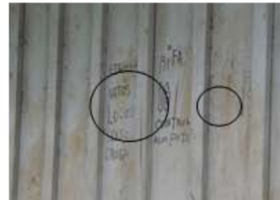
Foto No. 25 Fisuras y decoloración de pintura en muros, además presencia de manchas, tizne, polvo y telarañas en todos los muros de la estación.
