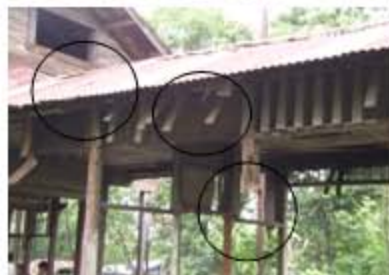
Foto No. 47 Oxidación en láminas, disgregación de elementos de las ventanas, puertas, muros interiores, columnas, destrucción de la madera por insectos, especialmente en columnas.
