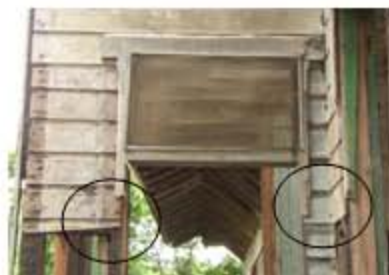
Foto No. 46 Disgregación parcial de muros, marcos de puertas y ventanas, decoloración en un 90% de todos los muros exteriores, de la estación, presencia de polvo y telarañas.
