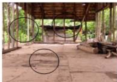
Foto No. 42 Pisos dañados, presencia de polvo, humedad y tierra, faltantes de elementos de carga vertical (paraes/columnas).
