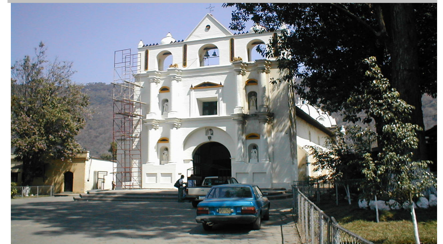
Iglesia Parroquial de San Lucas Tolimán Fotografía No. 6: En Segundo plano se puede apreciar, la fachada de la Iglesia parroquial, que estaba siendo intervenida para su restauración. Foto: Mayo del 2003
