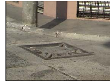
1. Cajas de telefonía instaladas en el suelo
