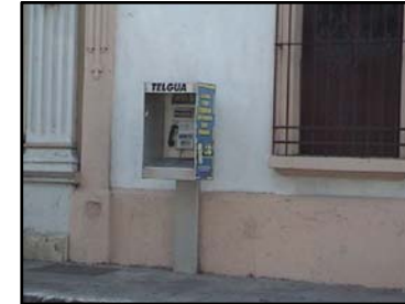
2. Tipo de cabinas instaladas en el Núcleo de Gestión Urbana
