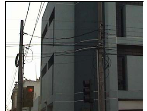
2. Cableado en la esquina de la 2da calle 6ta avenida, se observa lo crítico de la situación.
