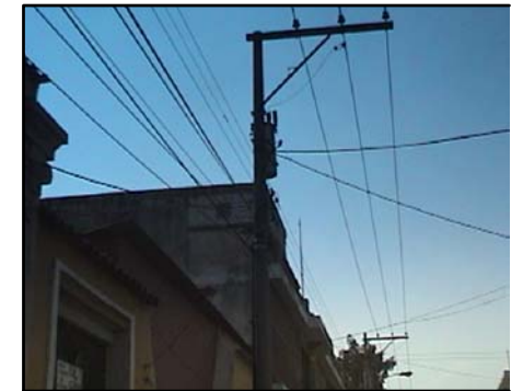
1. Líneas o cables sobre la 3ra calle y 6ta avenida "A"
