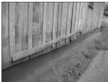
Imagen 128: En la fachada sur de la bodega, la plataforma y parte de los cimientos se encuentran expuestos, además la madera de los muros se está pandeando y tiende a levantarse.
