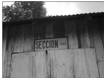
Imagen 124: El material original del portón de descarga era de madera, como todo el edificio, sin embargo actualmente es de lámina de zinc, detectando entonces una alteración de la bodega.
