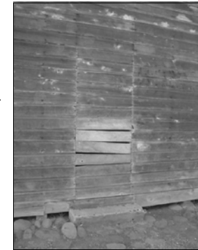
Imagen 93: Por lo visto, en este espacio existía una puerta, la cual fue cerrada, pero no recientemente, ya que la forma de la madera es similar, sin embargo se notan unas cuantas tablas que fueron agregadas.
