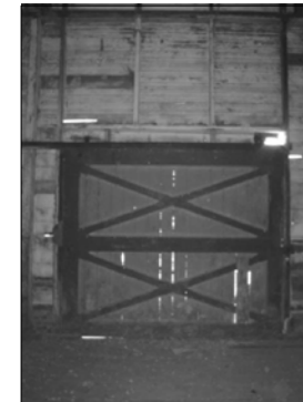
Imagen 100: Los portones internos de la estación tienen varias fisuras, y en algunas partes les hace falta alguna pieza.
