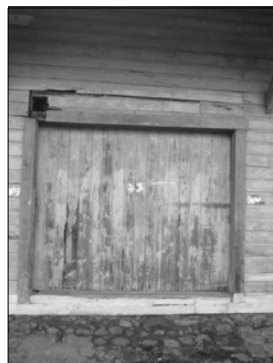
Imagen 114: Exteriormente, los portones se encuentran en mal estado, ya que varios factores han contribuido a su deterioro.
