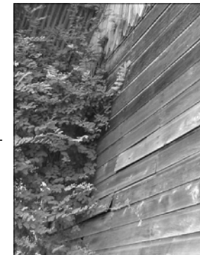
Imagen 111: Algo que contribuye al deterioro de la estación, es el arbusto que se encuentra justo a la par de esta fachada, ya que el mismo acumula humedad, animales e incluso puede ser causante de hongos que dañen el edificio.
