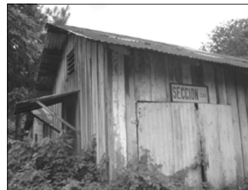
Imagen 123: Como se mencionó anteriormente, parte de la bodega también se encuentra bastante invadida de maleza, la que contribuye al deterioro del edificio por medio de humedades, hongos, insectos y otros diversos factores.
