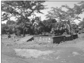
Imagen 90: Una clara alteración a la plataforma de la estación, es la publicidad política con pintura, la cual daña su estructura original.
