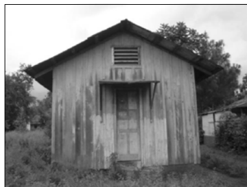
Imagen 137: Este es el aspecto de la fachada oeste, en donde a grandes rasgos se puede detectar que no hay homogeneidad en cuanto al acabado exterior, ya que el mismo se fue deteriorando con el paso del tiempo.
