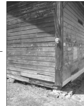
Imagen 96: Muchas de las paredes externas de la estación se encuentran rayadas o pintadas con publicidad. Además de esto, algunos de los conductores de electricidad son recientes y se encuentran expuestos.
