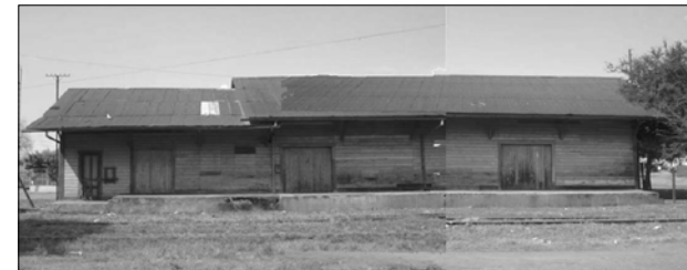
Imagen 120: En esta fachada sur, se detectaron varios deterioros, pero aún se conserva bastante bien, salvo manchas, rayones o publicidad pegada.
