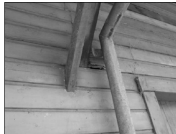
Imagen 95: Pareciera que la madera de la estructura que detiene la cubierta es reciente, ya que las originales se encuentran bastante deterioradas y dañadas.
