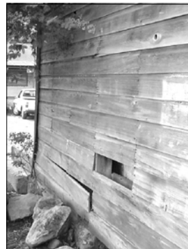
Imagen 110: Los agujeros en los muros, son deterioros bastante comunes en el edificio. También se puede notar que hay partes donde las piezas de madera se levantan, dando paso a la formación de otros agujeros.
