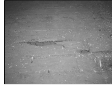
Imagen 98: Un factor que contribuye al deterioro de la estación, es que hay palomas que habitan en el interior de la misma, y por lo tanto hacen allí sus necesidades. Esto trae consigo varios factores, que hacen que poco a poco, la estación vaya perdiendo sus elementos originales.
