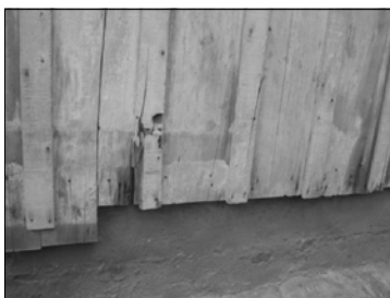
Imagen 130: La madera no es un material muy duradero, como se ve en la imagen, la misma se encuentra picada y bastante deteriorada.
