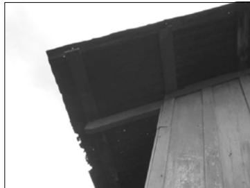
Imagen 135: La mayor parte de la cubierta de lámina se encuentra picada y oxidada, además la misma está bastante pandeada.
