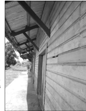
Imagen 118: Se puede verificar desde el pasillo, que esta parte se encuentra bastante bien, en cuanto a su estructura y texturas, a comparación de las otras caras del edificio.
