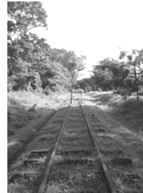
Imagen 84: Estado de la Vía Férrea en El Naranjo. Fuente: Visita de Campo.
