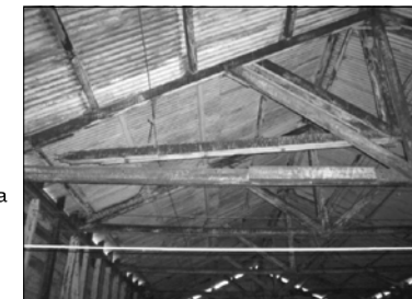
Imagen 104: La mayoría de la estructura interna de la estación se encuentra en regular estado, por ejemplo esta tijera, carece de un pedazo que va dar al apoyo vertical.
