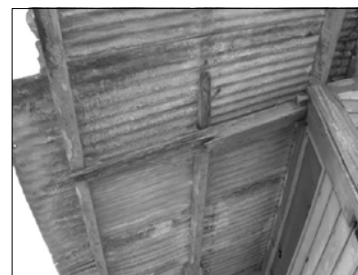
Imagen 116: La cubierta es de lámina, y ésta con el tiempo tiende a deteriorarse. Se puede verificar que en varios espacios, ésta se ha roto.
