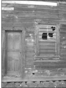
Imagen 105: La estructura de las puertas y ventanas no se encontró en tan mal estado, sin embargo, la mayoría de éstas carecen de algunos de sus elementos, como por ejemplo las cerraduras. Se nota también el deterioro de las paredes externas, ya que existen espacios que tienen agujeros u otros algún tipo de hongo dañino.
