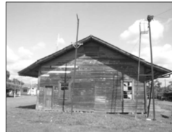
Imagen 107: El estado de esta fachada del edificio es bastante notoria, comenzando desde la cubierta que se encuentra totalmente pandeada, además ya en conjunto se visualiza mejor que las texturas no son para nada uniformes. También se puede observar que da la impresión que el edificio estuviera levantado del suelo.
