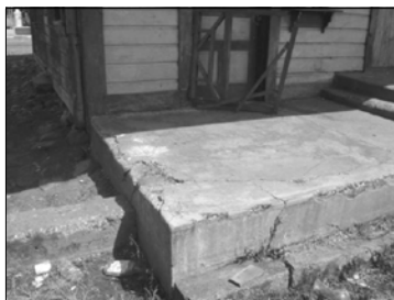
Imagen 99: La plataforma exterior de la estación también se encuentra bastante dañada, ya que tiene varias grietas y la maleza está penetrando en las mismas. Además, la contaminación creada por desechos o por la gente que hace sus necesidades, provoca su deterioro.
