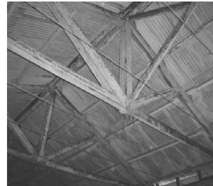
Imagen 81: Muestra la estructura del artesonado en el techo. Fuente: Visita de Campo Octubre 2004.
