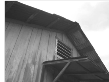
Imagen 136: Esta fachada se conserva bastante bien, sin tomar en cuenta el factor del decoloramiento de la madera que es inevitable.
