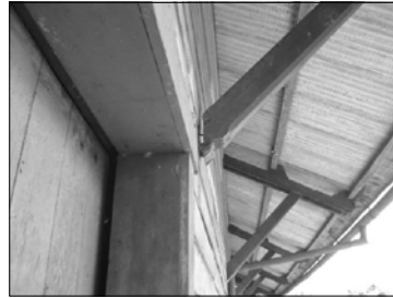
Imagen 117: La estructura de la cubierta se encuentra picada, en su mayoría, aunque todavía hay piezas que se conservan en regular estado.
