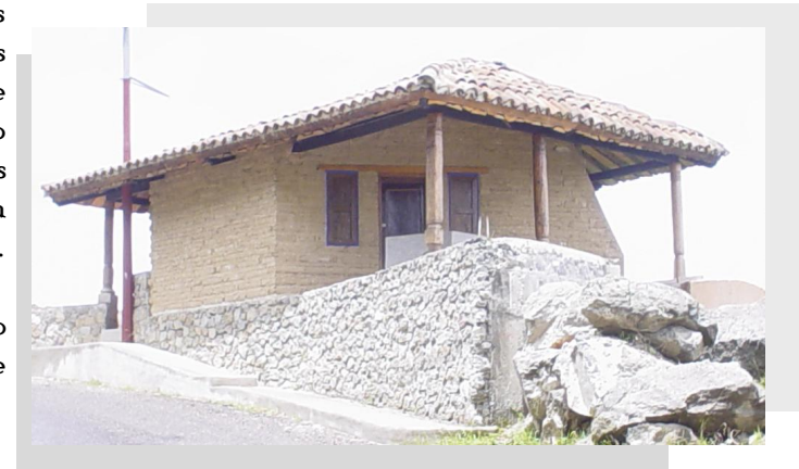
Artesonado de Teja y Madera, Columnas de Madera en bases de Piedra, Muros de Piedra y Adobe Expuesto. Refuerzo de Madera en los Dinteles de Puertas y Ventanas.
