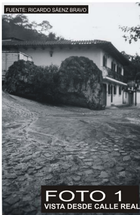
Vista de una de las casas de dos niveles que se encuentran en el entorno de las Ruinas de de Santa Inés, y que se observa también el gran fragmento desprendido de la fachada.
