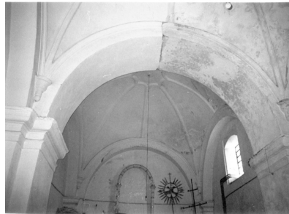
Fotografía No.26 daños y deterioros-sacristía
