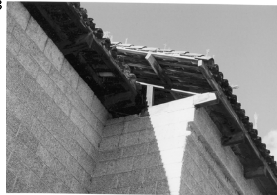
Fotografía No.34 deterioros en armadura De madera.
