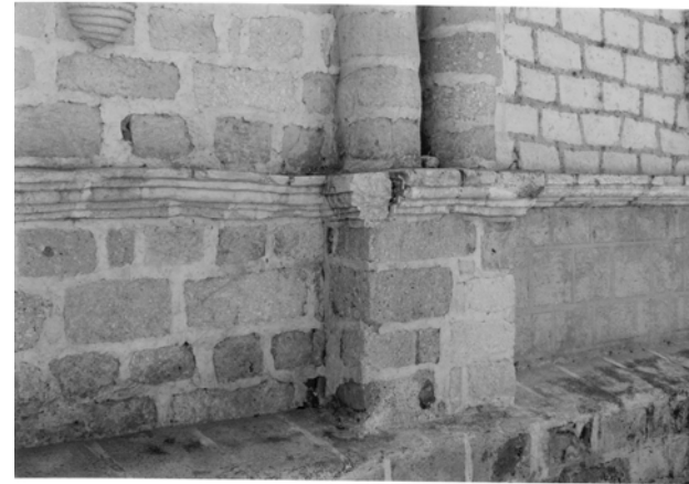
Fotografía No.32 disgregación de materiales (fachada oeste)
