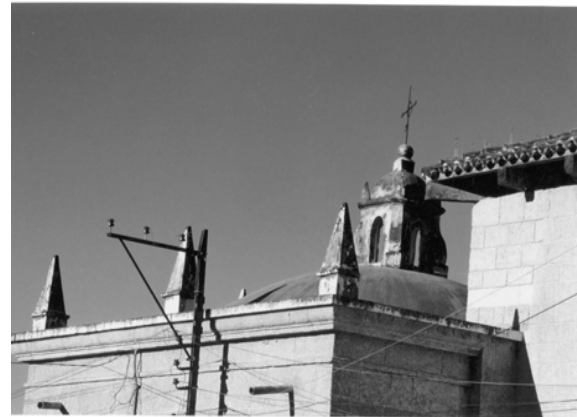
Fotografía No.39 daños en muros.
