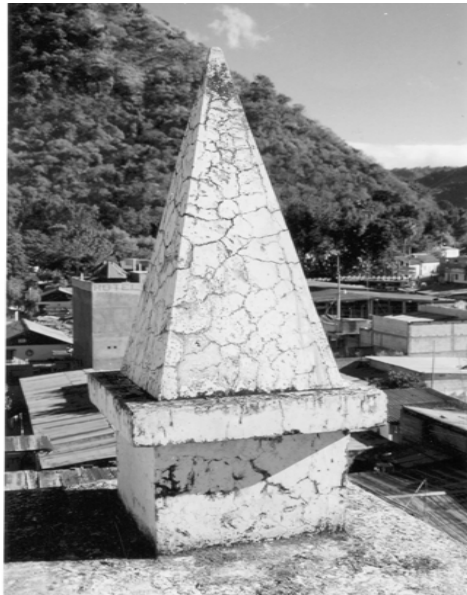
Fotografía No.38 daños en acabados.
