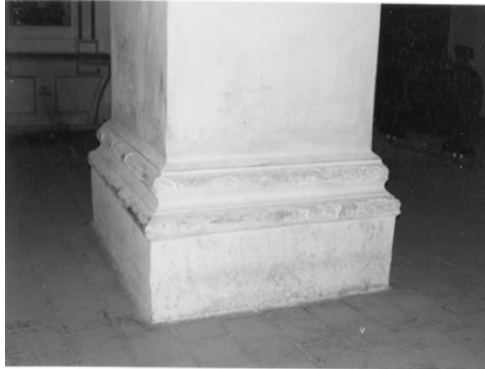
Fotografía No.35 deterioro en acabados.
