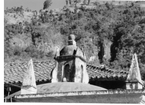
Fotografía No.37 hongos y desprendimiento de materiales.
