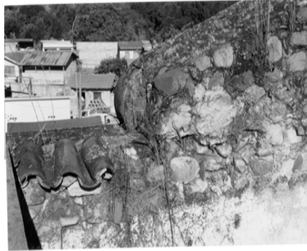
Fotografía No.36 disgregación de materiales en muros.
