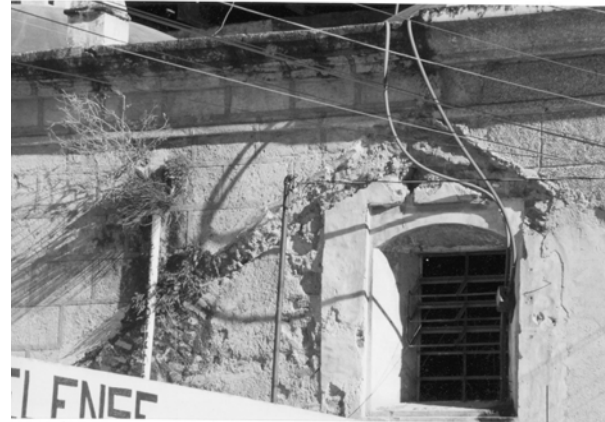
Fotografía No.28 daños y deterioros en muro de sacristía.
