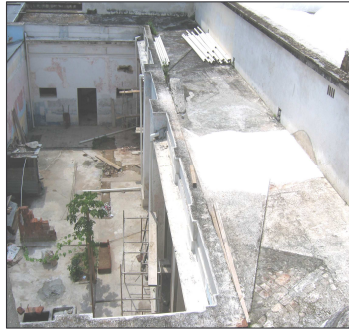
Liberación de acabados en mal estado, aplicación de fungicida, liberación de manchas de humedad, aplicación de impermeabilizantes.
