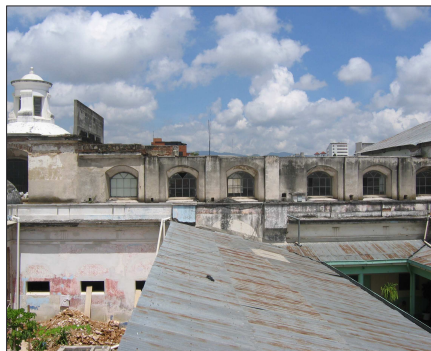
Integración de acabados y materiales faltante, integración de marcos de madera y vidrios.
