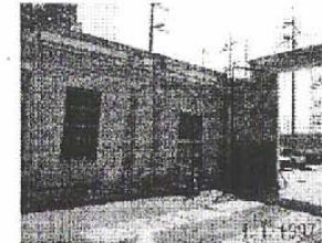
Foto Alteraciones en la fachada por la integracion de elementos.
