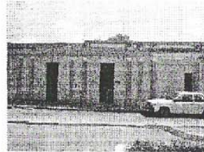
Foto . Se puede observar el mal estado del edificio.
