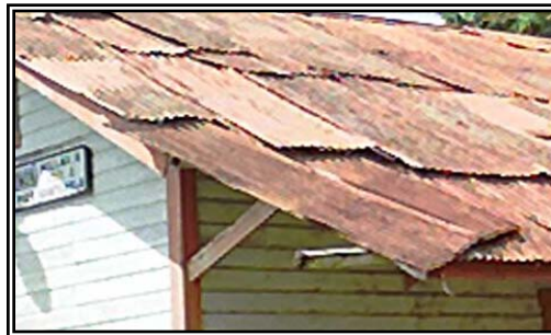
Foto No. 92, Esta toma presenta el estado actual de la cubierta, piezas desfasadas, y decoloración de la pintura anticorrosiva, así como todas las láminas deformadas causadas por el clima y la falta de mantenimiento.
