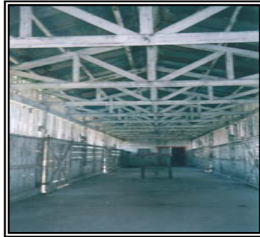
Foto No. 91, esta toma muestra los elementos horizontales formados por tendales en el caso de la estructura para techo, mientras que otras piezas horizontales hacen el refuerzo cumpliendo la función de soleras.
