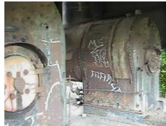
Estádo actual de las calderas
