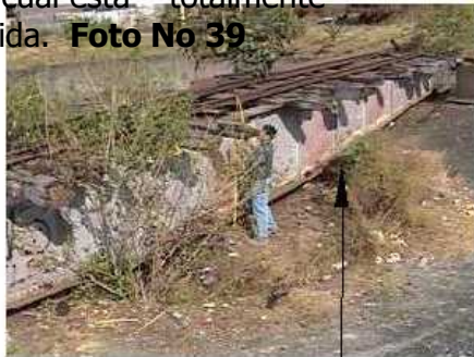
BASE DE METAL GIRATORIO PARA LOCOMOTORAS EN MAL ESTADO.
