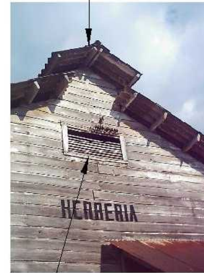
TECHO DE LÁMINA CON ESTRUCTURA DE MADERA EN REGULAR ESTADO
