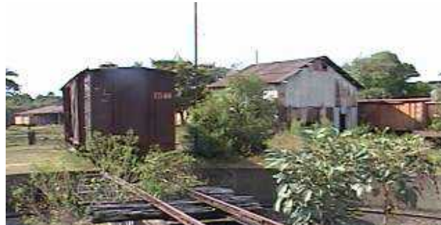
Grado de deterioro en que se encuentra la tornamesa. Foto No 40 Para ver más detalles de los deterioros ver el plano No.32
