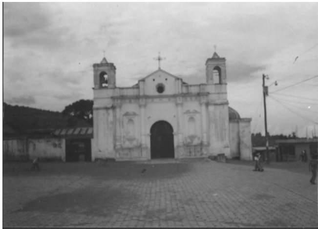
Fotografía No.3 Deterioro de la Fachada
